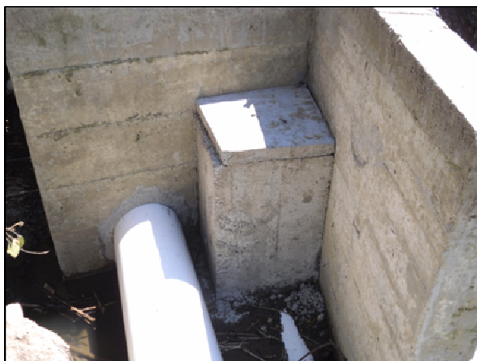
Figura 27. Revoque de aducción en la bocatoma
