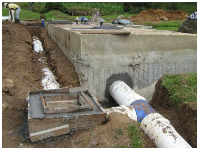
Figura 31. Revoque en inicio de conducción principal
