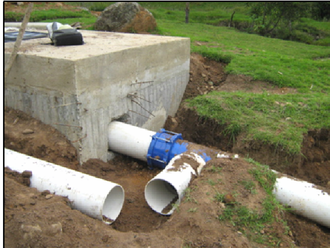
Figura 23. Parte final del BYPASS 12”
