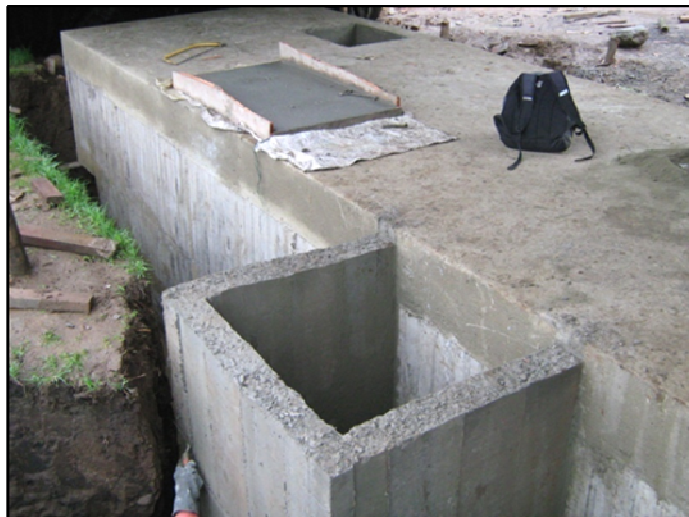
Figura 19. Cámara de lavado
