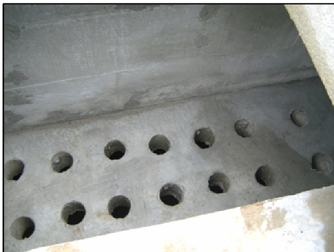
Figura 20. Cámara de aquietamiento
