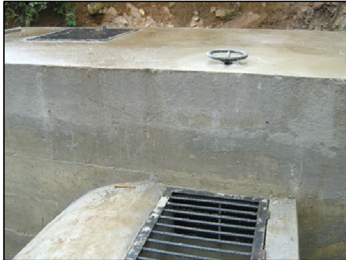
Figura 7. Rejilla, tapa de acceso y válvula de compuerta instaladas
