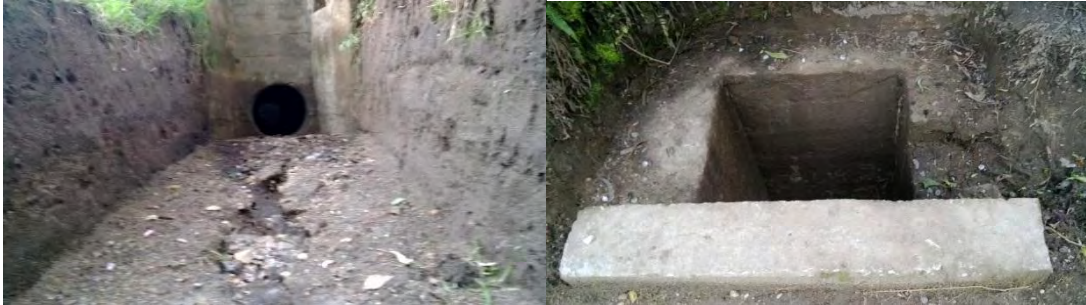
Figura 21. Limpieza de alcantarillas. Mantenimiento y mejoramiento de la vía Martín - La Estancia, en el Municipio de San Pedro de Cartago, Departamento de Nariño.
