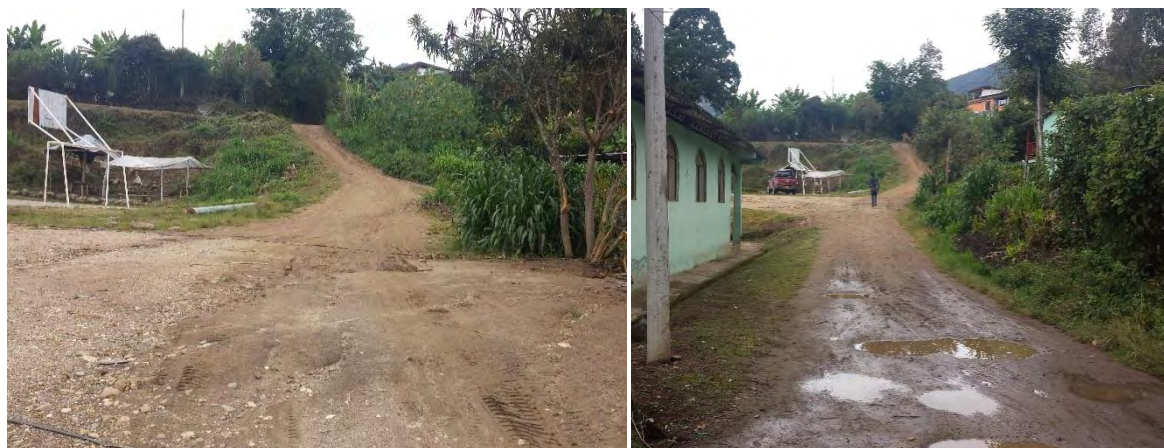
Figura 10. Estado inicial de la vía. Construcción placa huella en la Vereda “La Comunidad”, Municipio de San Pedro de Cartago, Departamento de Nariño
