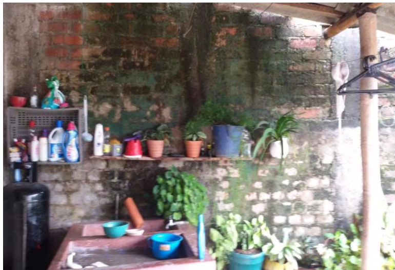
Figura 22. Humedad presente en muro de vivienda afectada.
