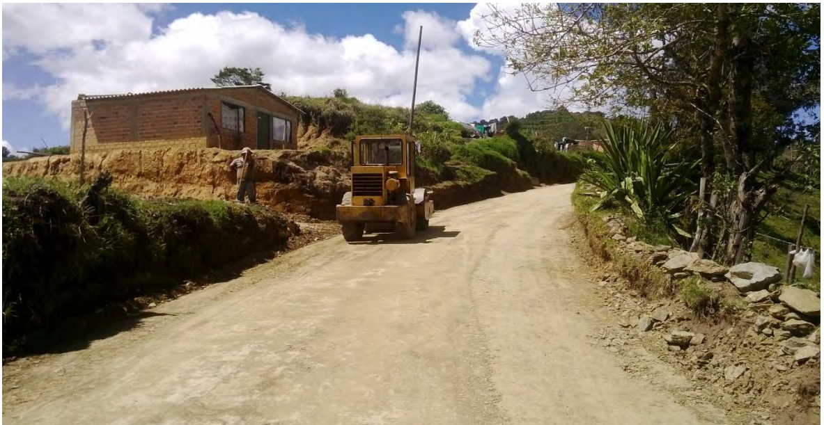
Figura 18. Compactación de base. Mantenimiento y mejoramiento de la vía Martín - La Estancia, en el Municipio de San Pedro de Cartago, Departamento de Nariño.
