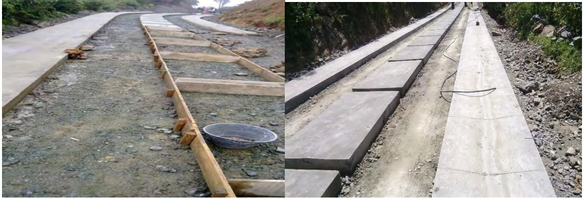
Figura 19. Estructuras en concreto ciclópeo placa huella. Mantenimiento y mejoramiento de la vía Martín - La Estancia, en el Municipio de San Pedro de Cartago, Departamento de Nariño
