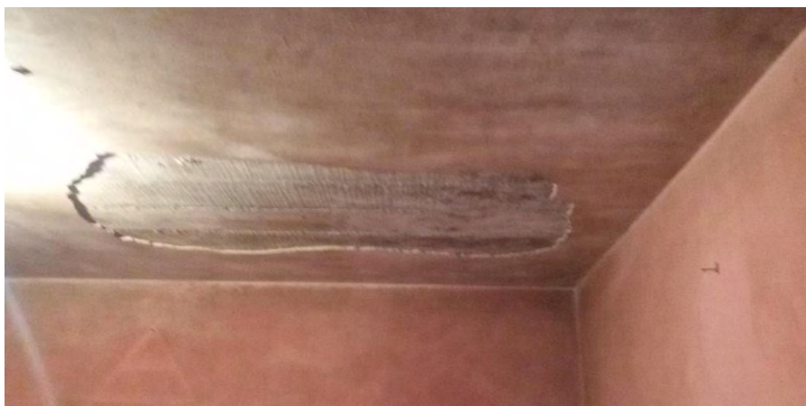
Figura 24. Humedad presente en losa de entrepiso de vivienda afectada.
