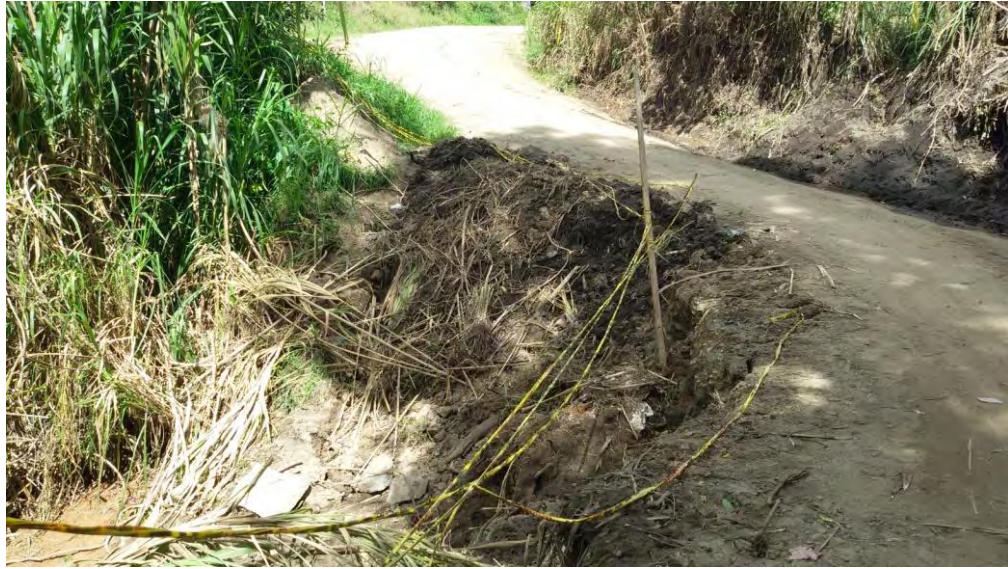
Figura 29. Deslizamiento vía que conduce de la cabecera municipal, a la Vereda “El Salado”, Municipio de San Pedro de Cartago, Departamento de Nariño, sector aledaño a la ladrillera del Señor Raúl Gómez.
