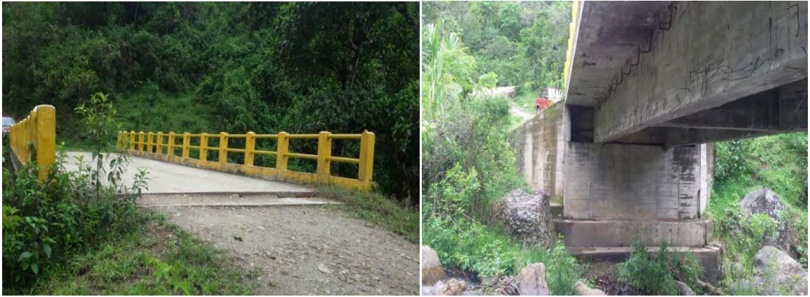
Figura 27. Puente Chimayoy Bajo San Antonio – San Bernardo en el Pr 6 + 800, de la vía que conduce de la vereda Chimayoy Bajo, Municipio de San Pedro de Cartago, a la Vereda San Antonio, Municipio de San Bernardo en el Departamento de Nariño.
