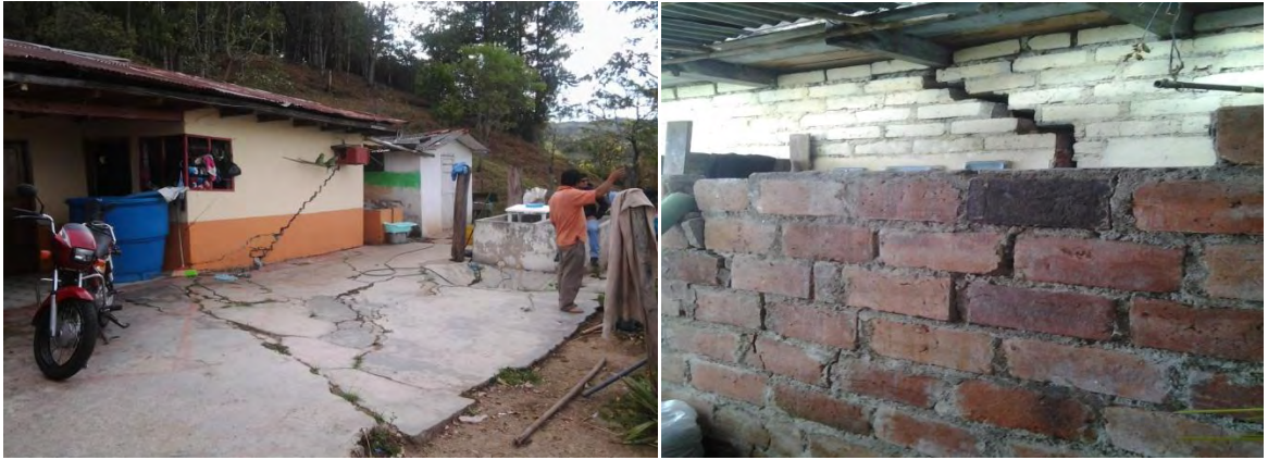
Figura 26. Afectaciones vivienda Miguel Domínguez
