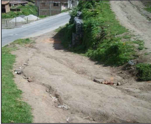
Foto 85. Estado Inicial Entrada Vía Perimetral
