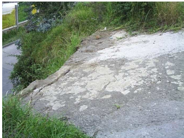
Fotografía 3. Grietas observadas en Talud 2
