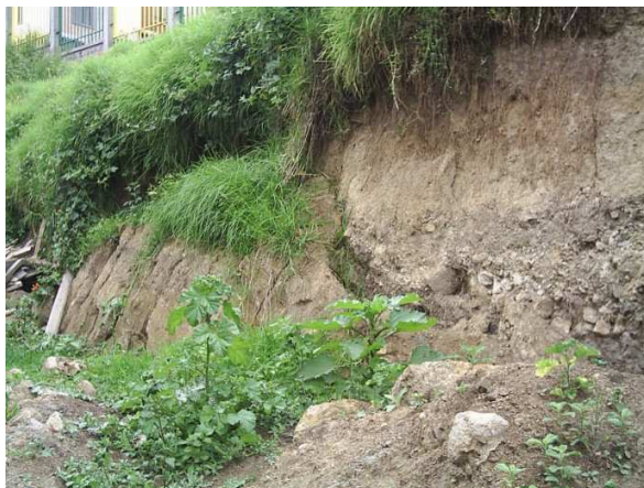
Fotografía 5. Paredes deslizadas del TL3 y variación de estratos en la altura del talud.
