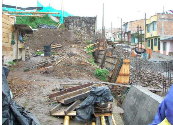
Fotografía 64. Muro en gaviones
