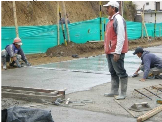
Fotografía 30. Microtextura con caucho de neumático
