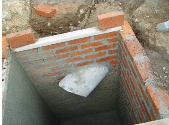
Fotografía 58. Conexión sumidero tubería
