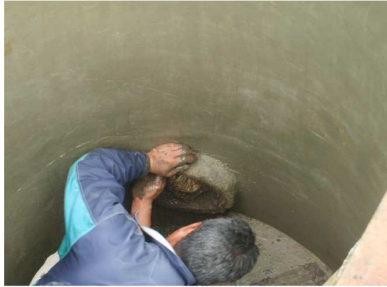
Fotografía 53. Cámara de inspección esmaltada parte interior
