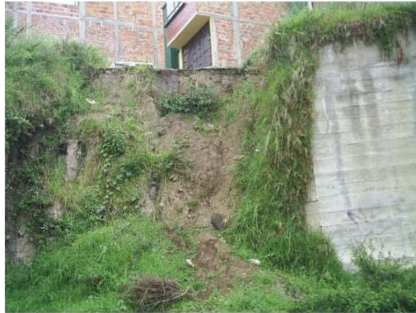
Fotografía 2. Deslizamiento del TL2. Falla circular activada, en la corona del talud se observaron grietas que muestran las superficies de nuevos deslizamientos.
