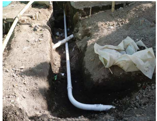
Imagen 60. Tubería \varnothing=3'' PVC.
