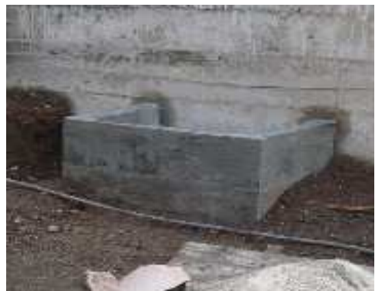
Imagen 72. Cajilla en concreto.
