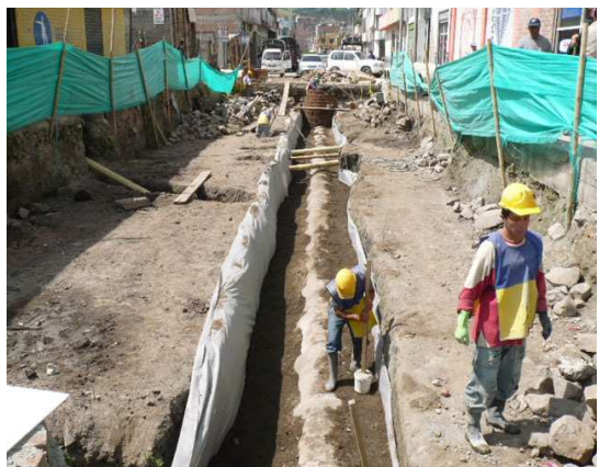
Imagen 200. Alcantarillado tubería en concreto 24"
