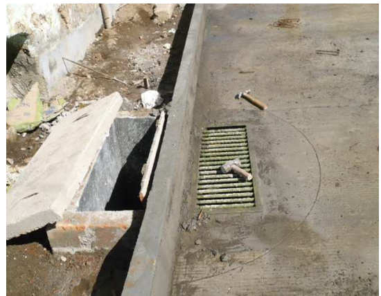
Imagen 74. Sumidero rejilla y tapa.
