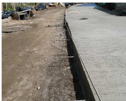
Imagen 85. Placa refuerzo longitudinal.
