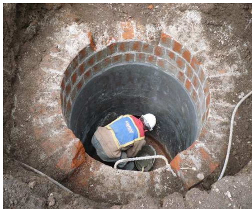
Imagen 62. Cámara de inspección.
