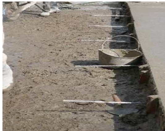
Imagen 128. Placa refuerzo longitudinal.
