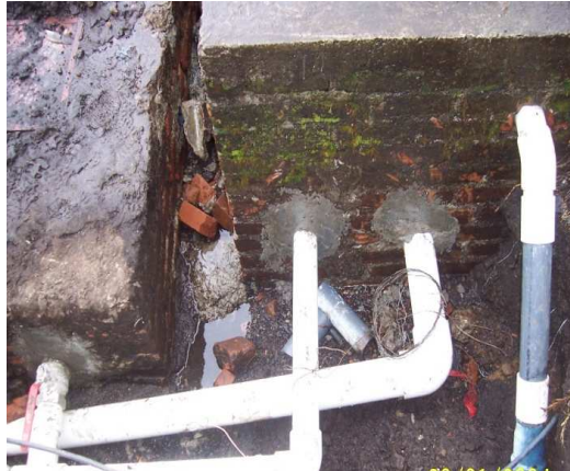
Fotografía No. 35 Instalaciones hidráulicas en la cámara repartidora de caudales.
