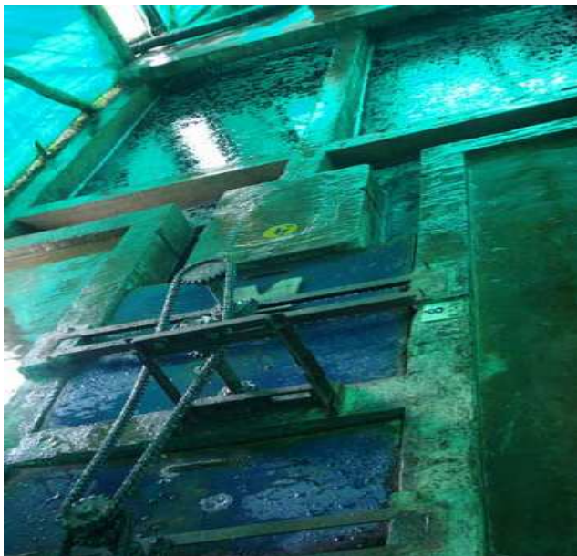
Figura No. 10. : Floculadores
