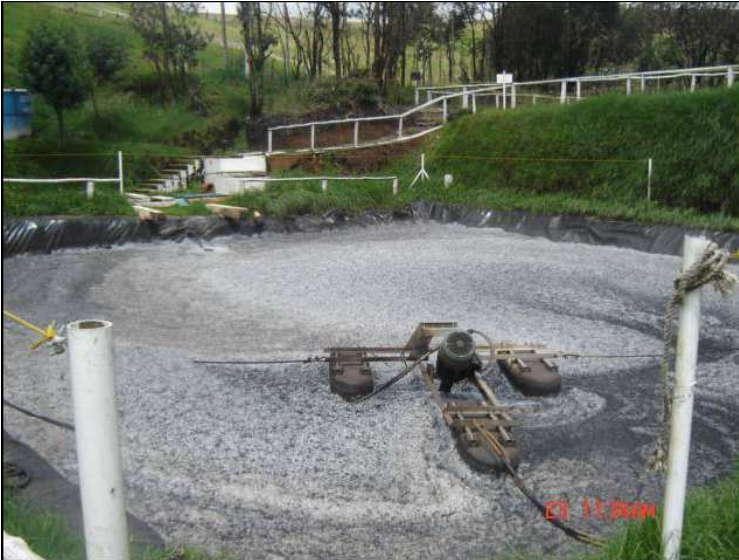
Figura No. 7. Piscina Aerobia
