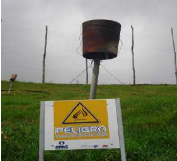
Figura No. 4: Chimenea para control de gases
