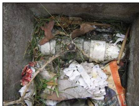
Llave de Paso LI 14 Localizada cerca al parqueadero principal
