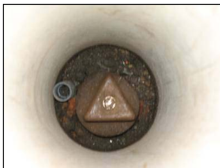
Llave de Paso LI 1 Localizada cerca de la entrada principal
