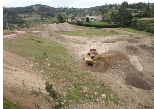
Figura 20. Botadero vista general
