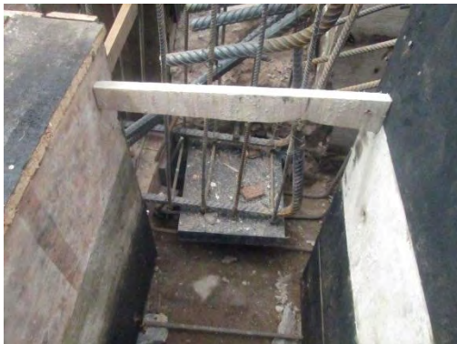
Figura 116. Neopreno vigas pontón 1
