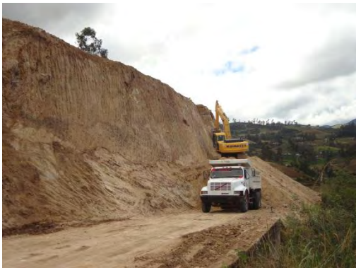
Figura 8. Corte talud k0+510
