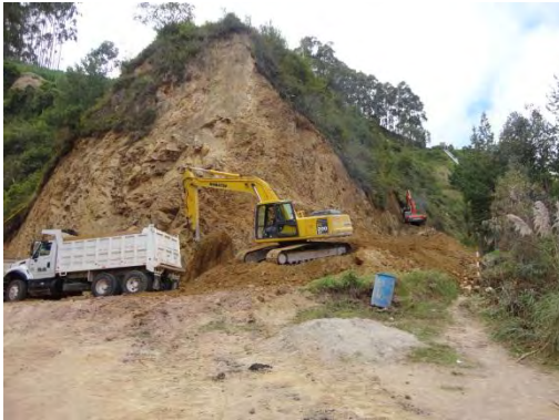
Figura 6. Corte talud k2+490
