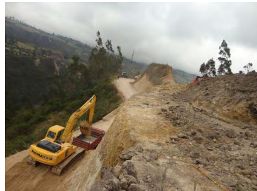
Figura 9. Corte talud k0+530
