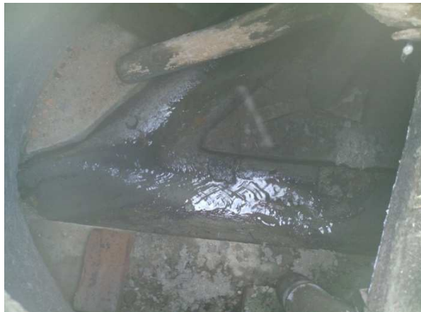
Figura 19. Pozo de inspección en Unidad Medica con escombros de formaleta (C2-N2)
