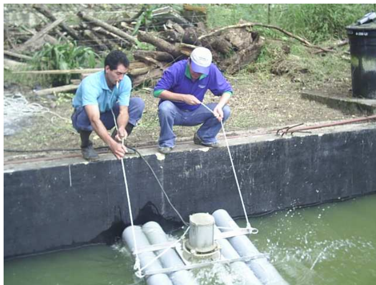
Figura 27. Instalación equipo Splash
