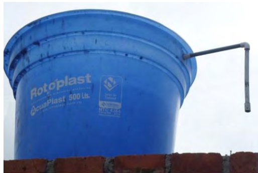
Figura 14. Tanque de almacenamiento de agua.
