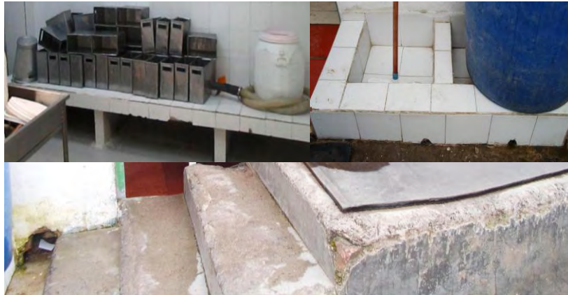
Figura 4. Instalaciones en mal estado
