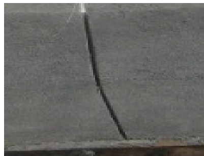
Imagen 108. Dilatación en cunetas
