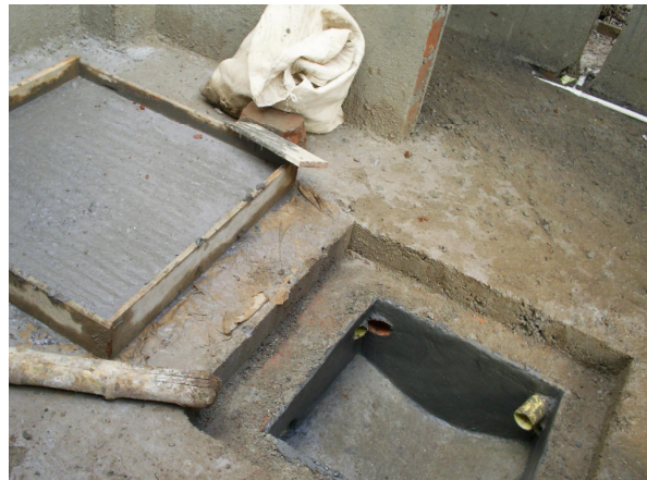
Imagen 34. Caja de inspección
