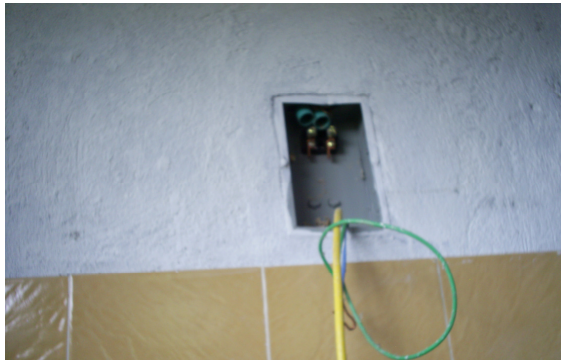
Imagen 44. Caja de breakers
