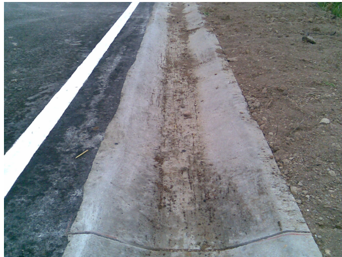
Imagen 89. Dilatación en cunetas
