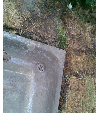
Imagen 107. Conexión aguas lluvias
