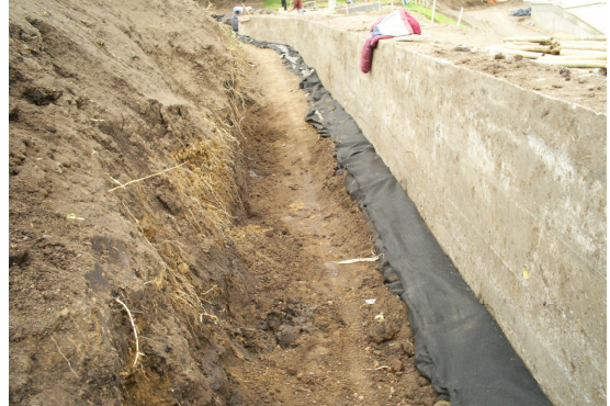
Imagen 15 .Filtro con geotextil
