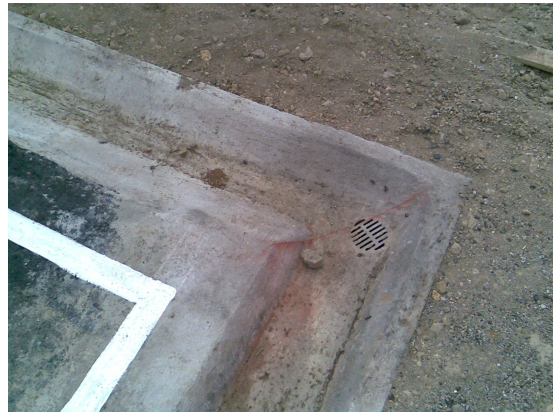
Imagen 88. Conexión a caja de inspección
