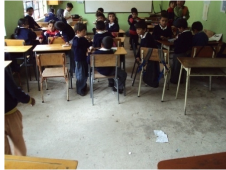
Figura 73. Piso de salones en condiciones iniciales
