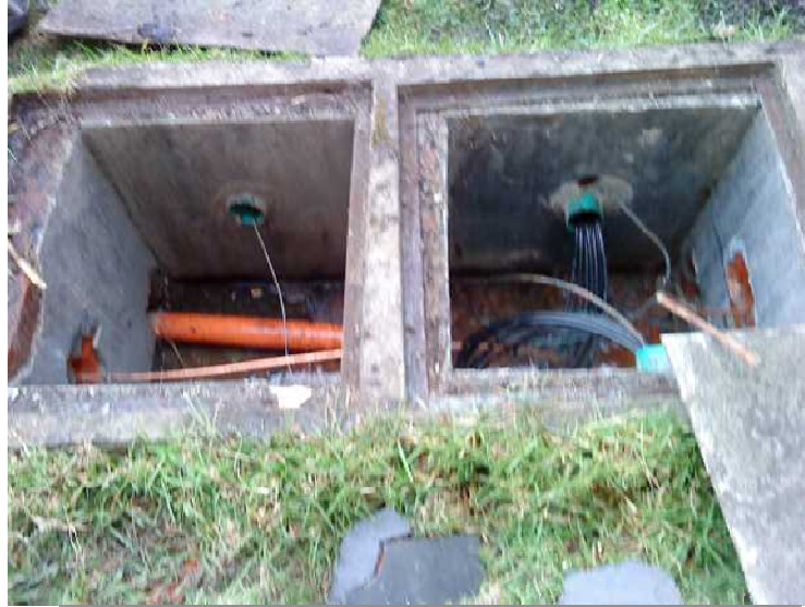
Ilustración 1 Acometida trifásica subterránea
