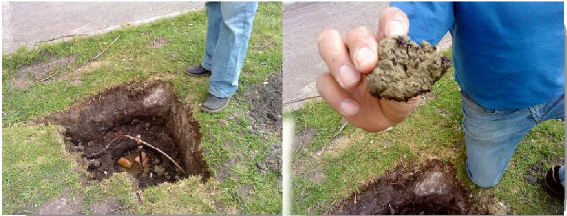
Ilustración 6 Sistema puesta a tierra con el tratamiento químico hidrosolta
