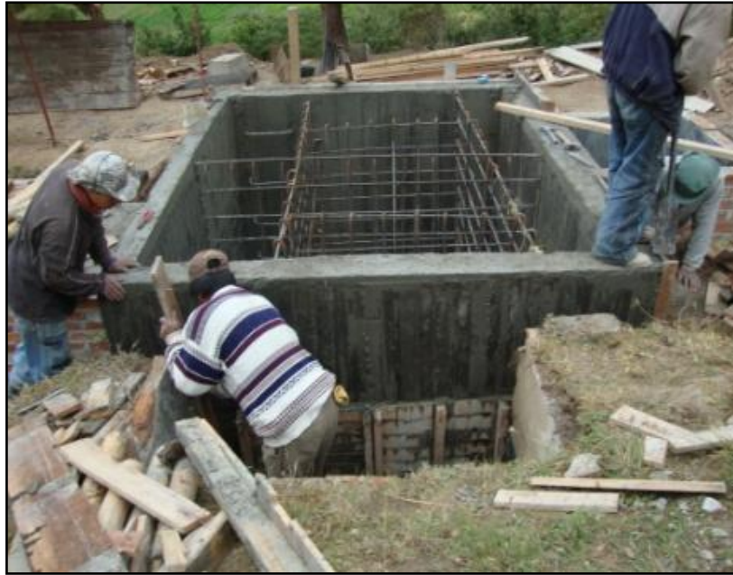
Figura 11. Parte exterior del sistema de filtración
