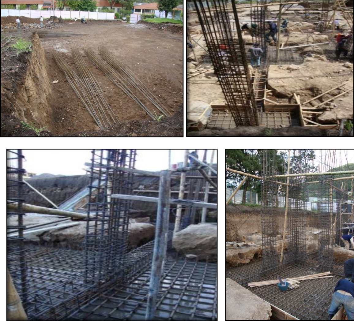
Figura 35. Acero de refuerzo A-60 (columnas y pantallas)
