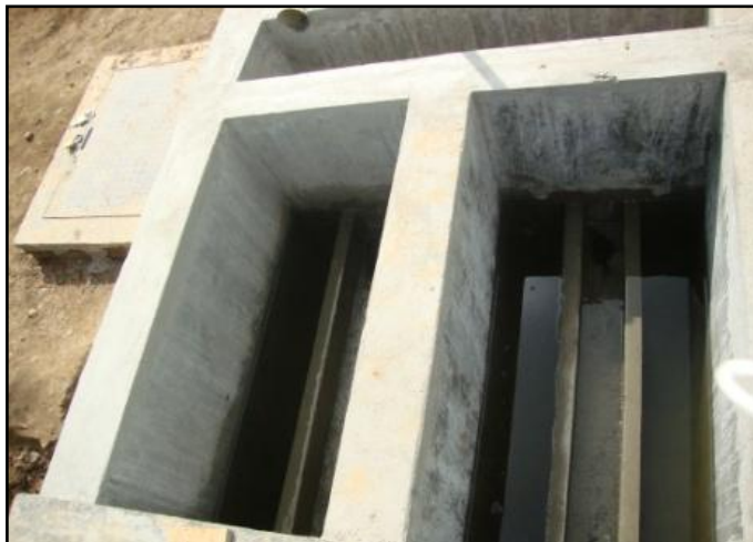
Figura 18. Sistema de filtración terminado y en funcionamiento
