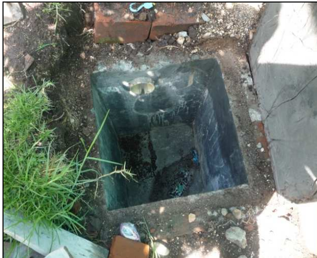
Ilustración 69 Caja de inspección de 0.6 x 0.6 x 1 m
