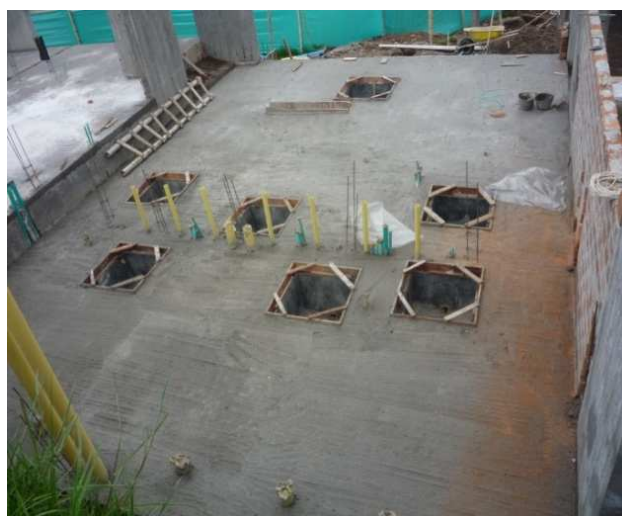
Ilustración 74 Instalaciones eléctricas adicionales
