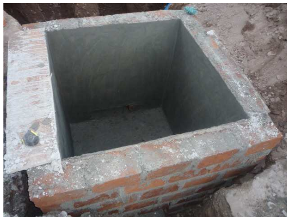
Ilustración 59 Caja de inspección
