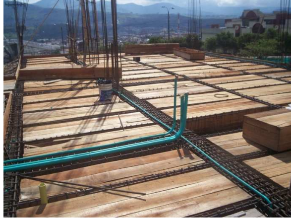
Ilustración 50 Tubería conduit para instalaciones eléctricas, voz y datos
