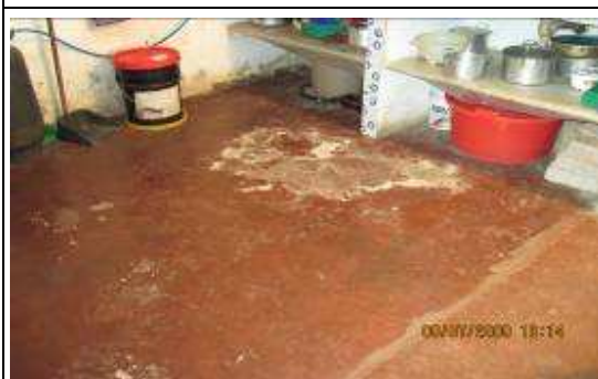
PISO COCINA ANTES
