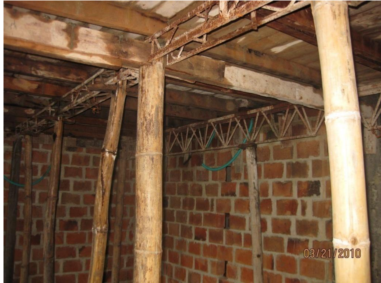
Figura 29 Actividad: Vista inferior de curado de losa aligerada
