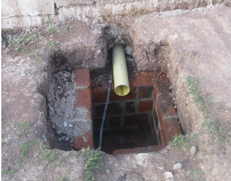
Figura 22 Actividad: Cajilla de recolección de aguas servidas o trampa de grasas
