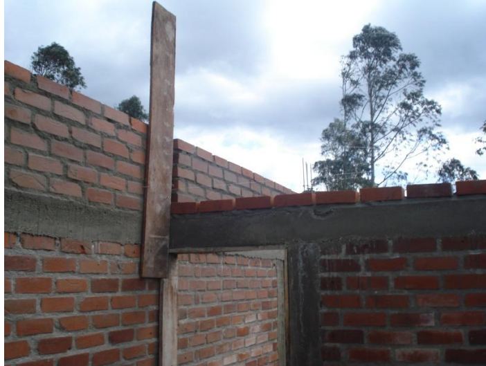
Figura 8 Actividad: Levantamiento de muros de tímpanos. Localización: Vereda San Jose del Cidral
