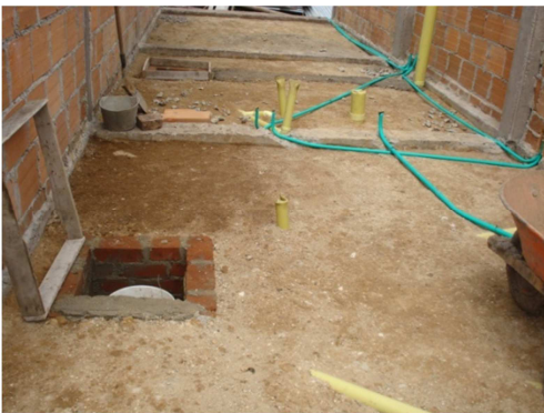
Fig. 44. Puntos sanitarios instalados en 1 piso
