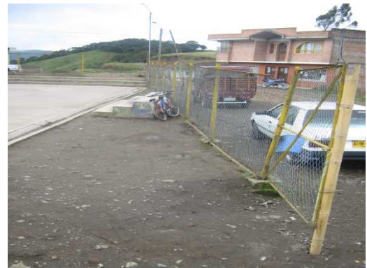
Imagen 27. Cerramiento y graderías no Adecuadas
