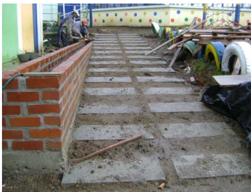
Imagen 34. Base en losetas en concreto.
