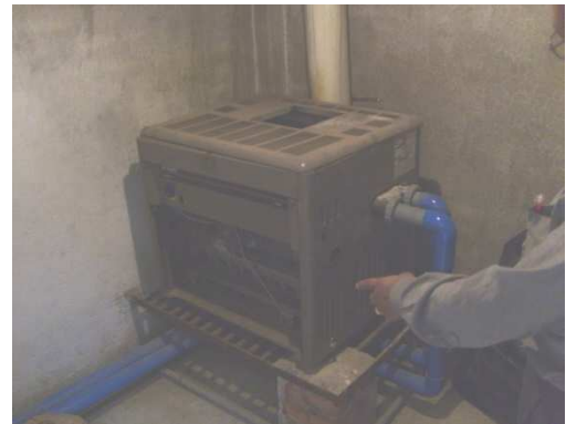
Imagen 23. Calentador sin sistema de Encendido
