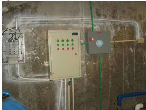
Imagen 21. Cuadro eléctrico de control
