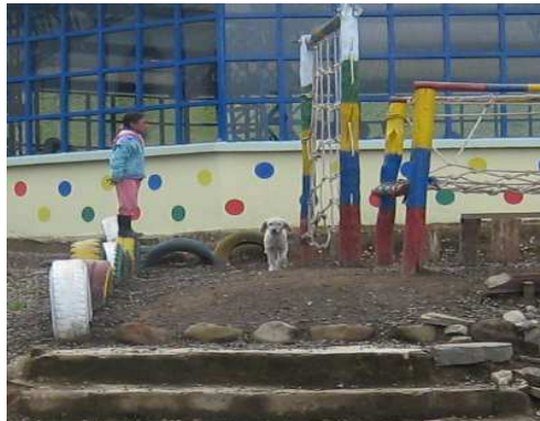
Imagen 32. Gradas en mal estado.
