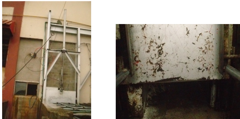
Figura 29. Compuerta del cajón de noqueo
