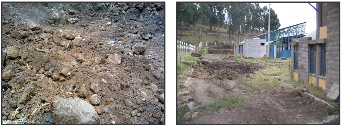
FIGURA 58. Conglomerado y roca en la vía 1 que dificulta la excavación mecánica.
