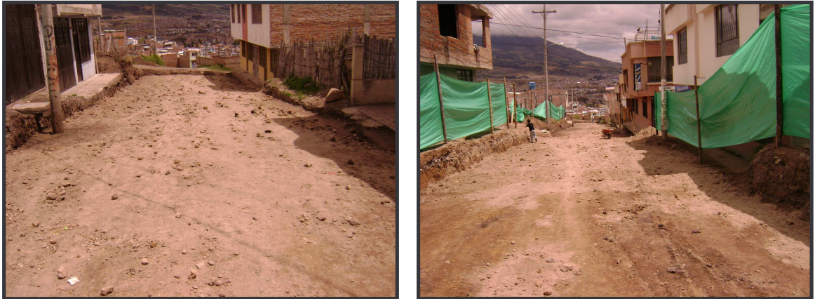
FIGURA 28. Afirmado en algunas zonas de la vía.
