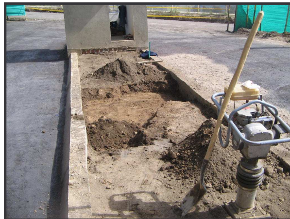
FIGURA 111. Retiro de material saturado de agua y relleno con recebo, en andén.
