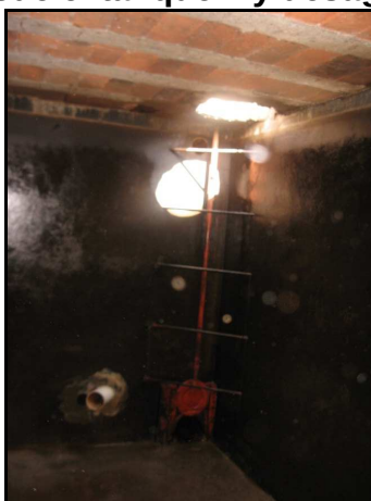
Foto: 44. Salida a la red desde el tanque 1 y desagüe
