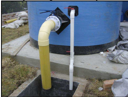
Foto: 62. Tubería de lavado y desagüe del tanque Floculador - Sedimentador
