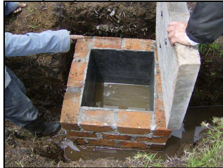
Foto: 86. Inundación de la cajilla por que no se instaló un desagüe
