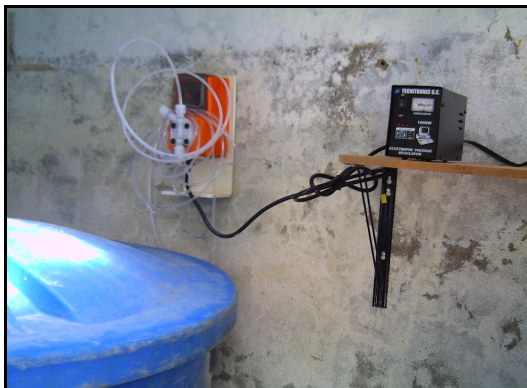
Foto: 8. Dosificador automático de cloro
