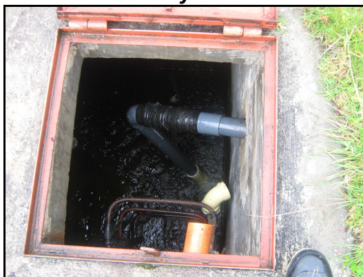
Foto: 4. Mal estado de los accesorios y tuberías de entrada
