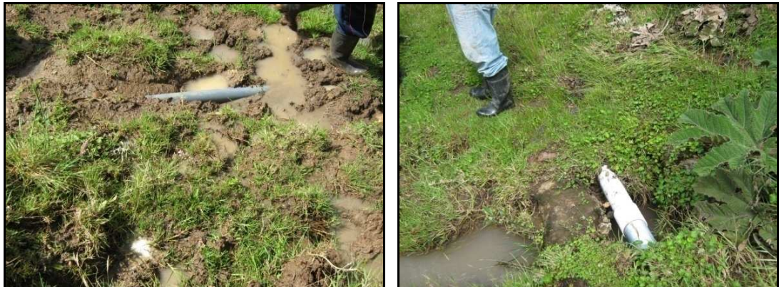
Foto: 12. Línea de conducción
