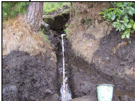
Foto: 87. Rompimiento de tubería
