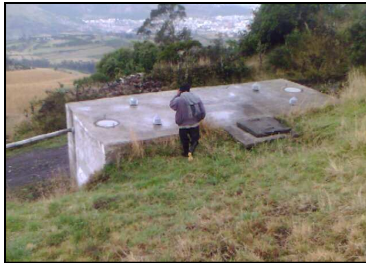
Foto: 34. Tanque de EMPOPASTO
