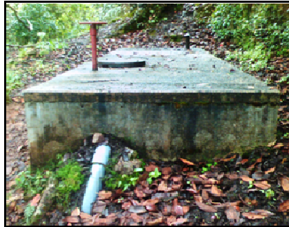
Foto: 20. Desarenador 1 de la bocatoma El Tambillo
