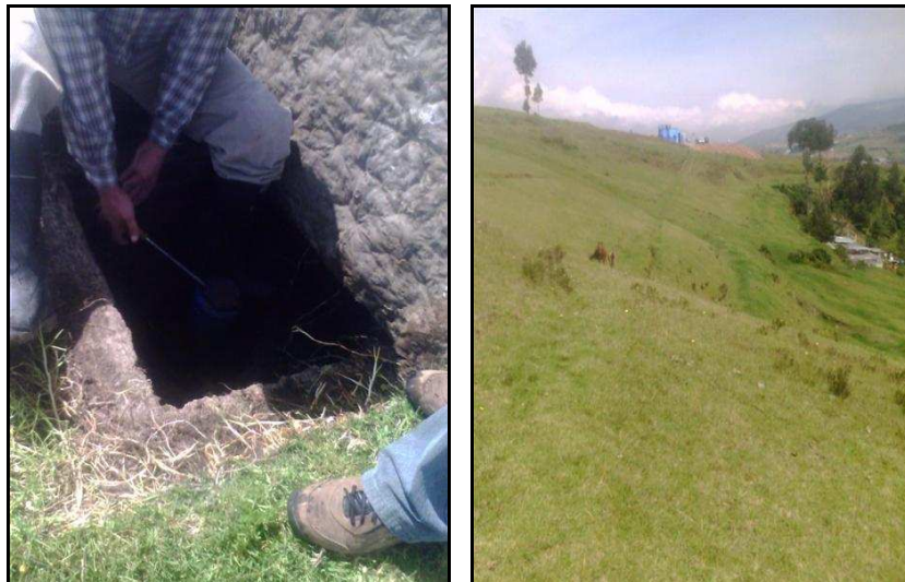
Foto: 91. Revisión de válvula ventosa
