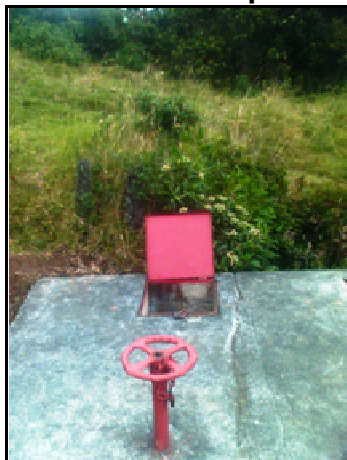
Foto: 46. Salida del tanque existente al tanque nuevo
