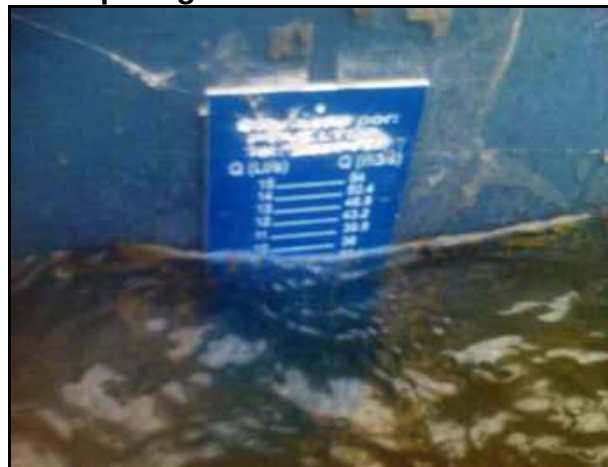
Foto: 97. Caudal de 10 lps registrado en el canal de mezcla
