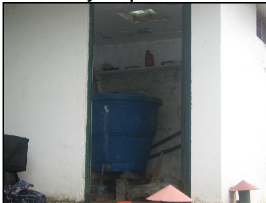
Foto: 7. Caseta de desinfección y tanque mezclador de cloro
