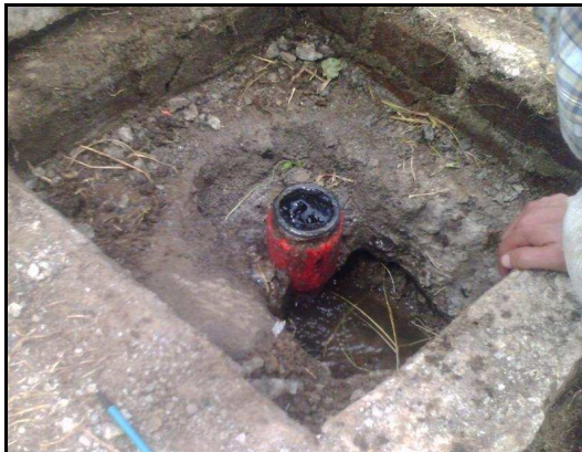
Foto: 92. Revisión de válvula ventosa
