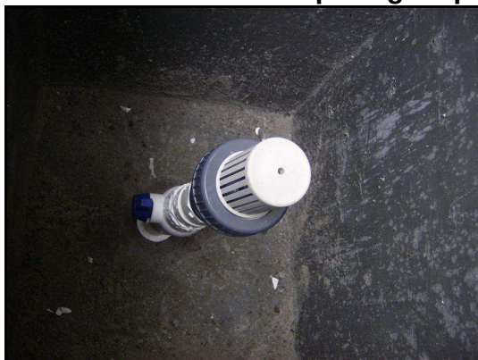
Foto: 84. Válvula ventosa protegida por cajilla
