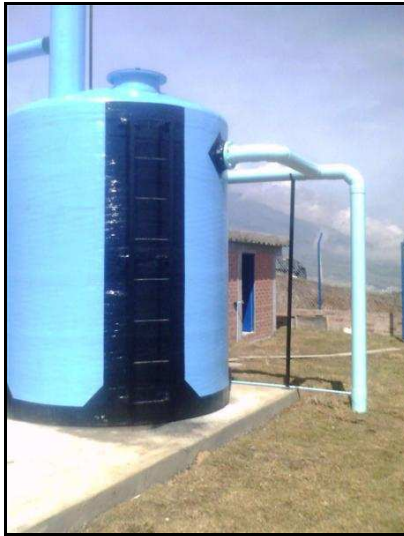
Foto: 69. Salida del agua filtrada a la red de distribución
