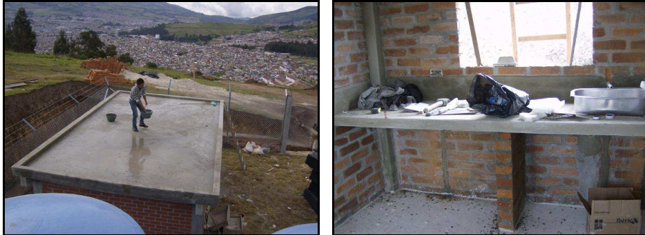
Foto: 64. Caseta de desinfección
