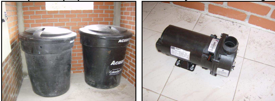
Foto: 65. Tanques de preparación de soluciones y bomba centrífuga
