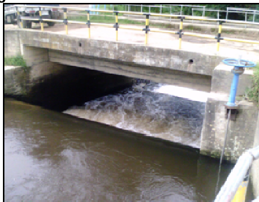
Foto: 39. Salida de aguas al río Pasto
