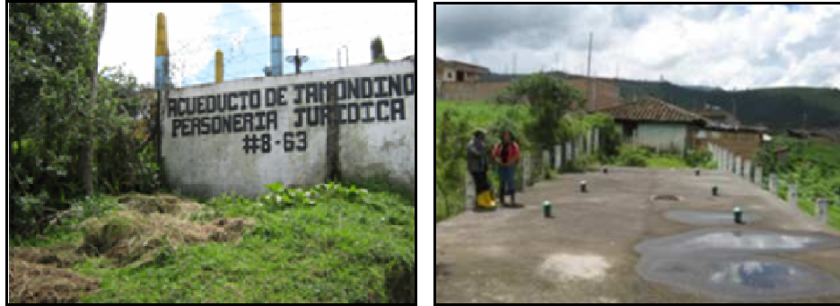
Foto: 14. Tanques de almacenamiento para Jamondino y El Rosario
