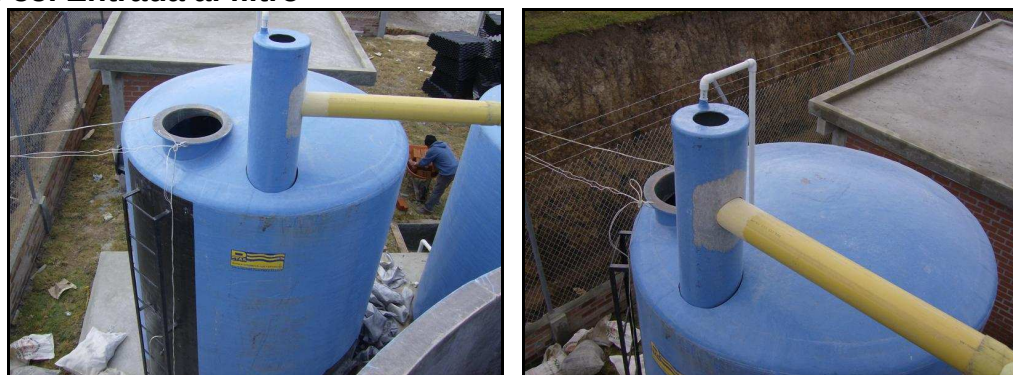
Foto: 55. Entrada al filtro
