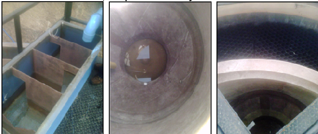
Foto: 68. Canal de mezcla, tanque floculador y tubos de sedimentación
