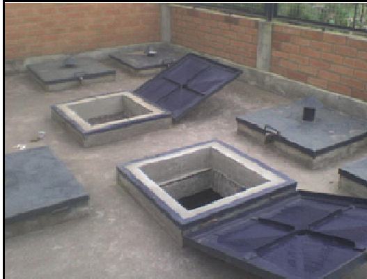
Foto: 24. Tanque para Puerres y Canchala
