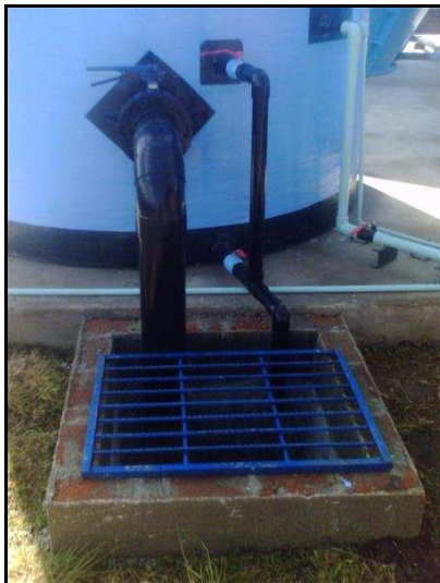
Foto: 70. Detalle tuberías de salida de los filtros
