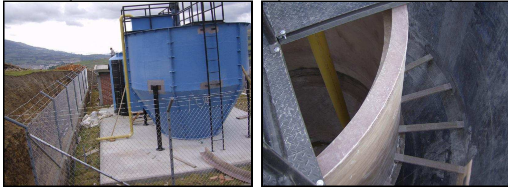
Foto: 54. Compartimentos de floculación y sedimentación de la planta
