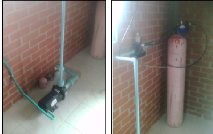
Foto: 72. Conexión de la bomba al cilindro de cloro gaseoso
