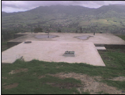
Foto: 23. Tanques para Mocondino
