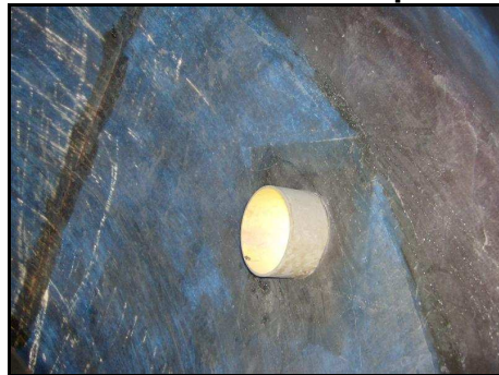
Foto: 57. Salida del agua filtrada a la cámara repartidora de caudales
