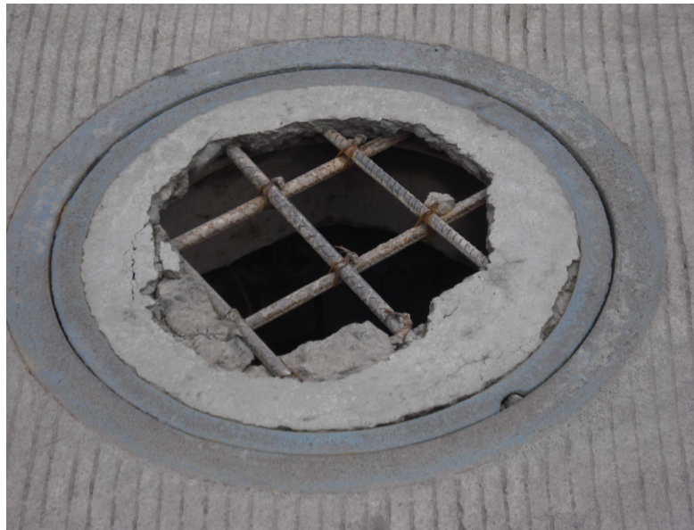
Figura 10. Detalle tapa destruida.
