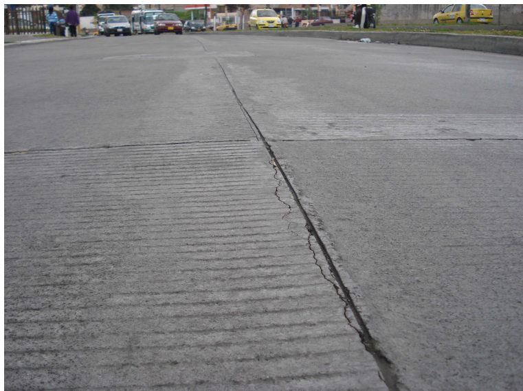
Figura 7. Detalle de fisuras presentadas a lo largo de la junta longitudinal.
