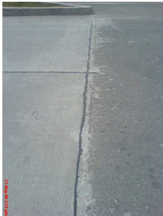
Figura 8. Detalle junta transversal reparada.
