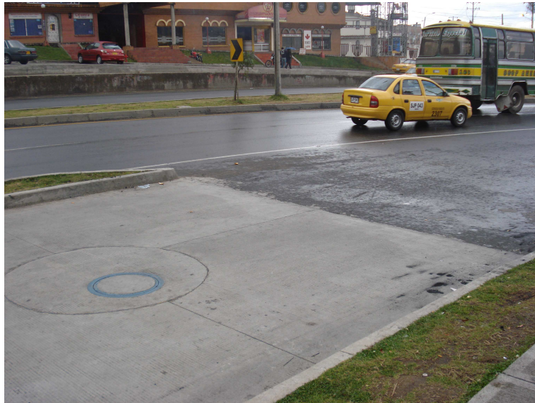
Figura 6. Ubicación de Fisura transversal.
