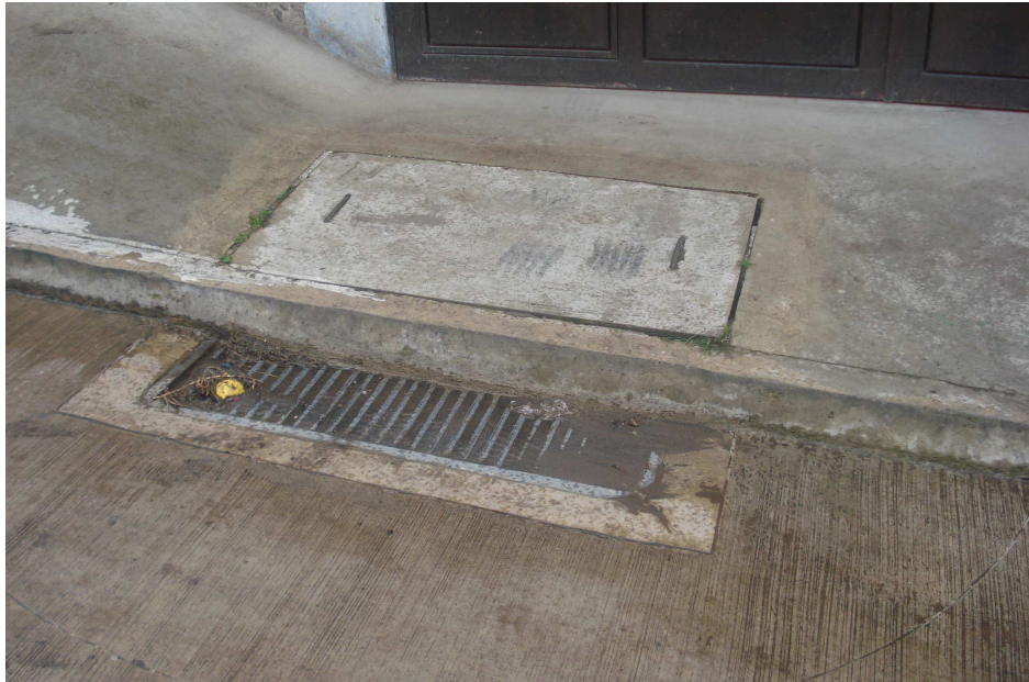
Figura 44. Detalle Sumidero bloqueado por material de arrastre.
