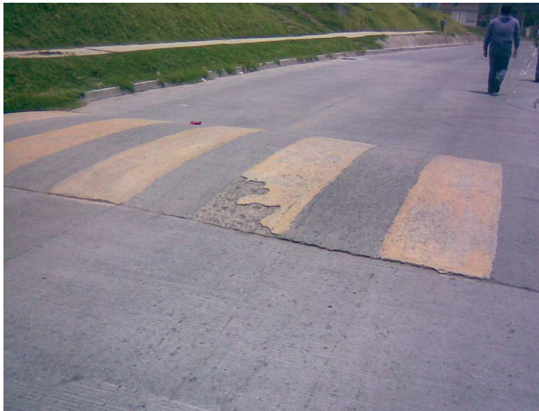
Figura 24. Resalto ubicado en San Albano fase I.
