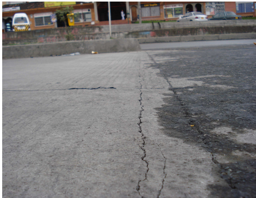
Figura 5. Fisura transversal al inicio de la obra.
