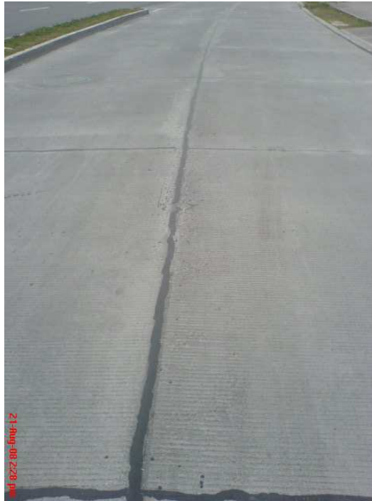
Figura 9. Detalle fisura longitudinal reparada.
