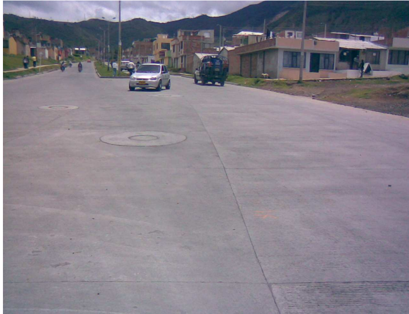
Figura 21. Inspección del estado de la placa de pavimento.
