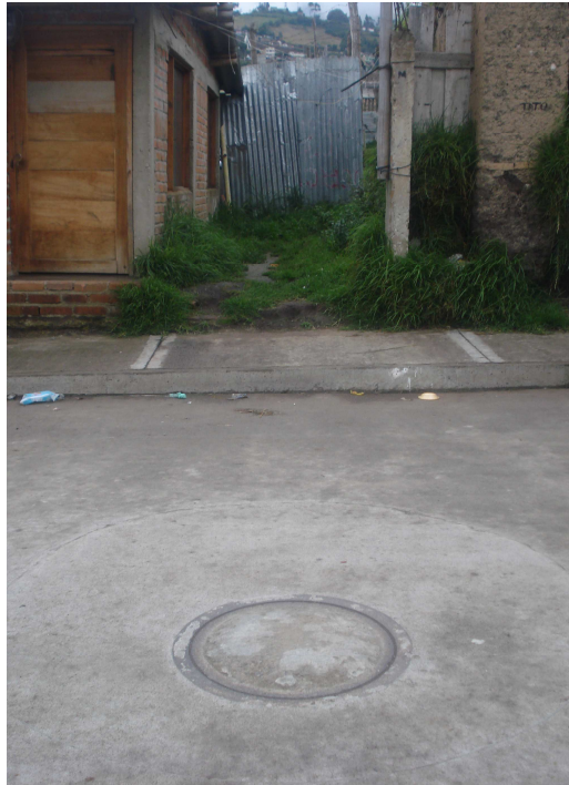
Figura 30. Cámaras de alcantarillado para dar servicio a lotes del sector.
