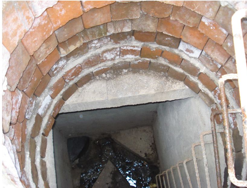
Figura 4. Cámara de convergencia de flujos Sanitario y Pluvial.
