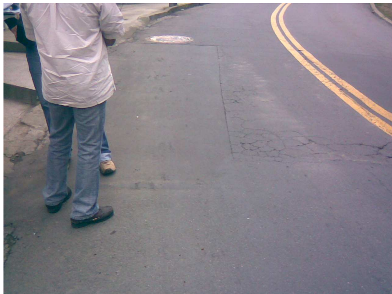
Figura 38. Parche localizado frente a Harricos.
