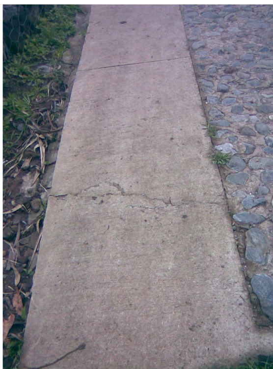
Figura 33. Detalle de loseta fisurada.
