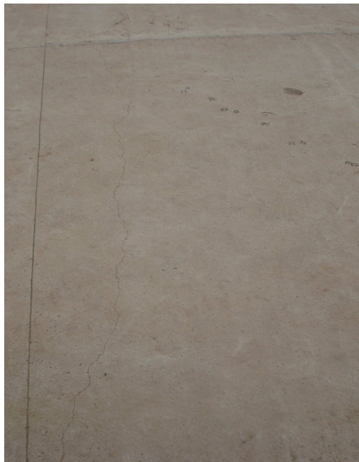
Figura 52. Detalle de paño fisurado.
