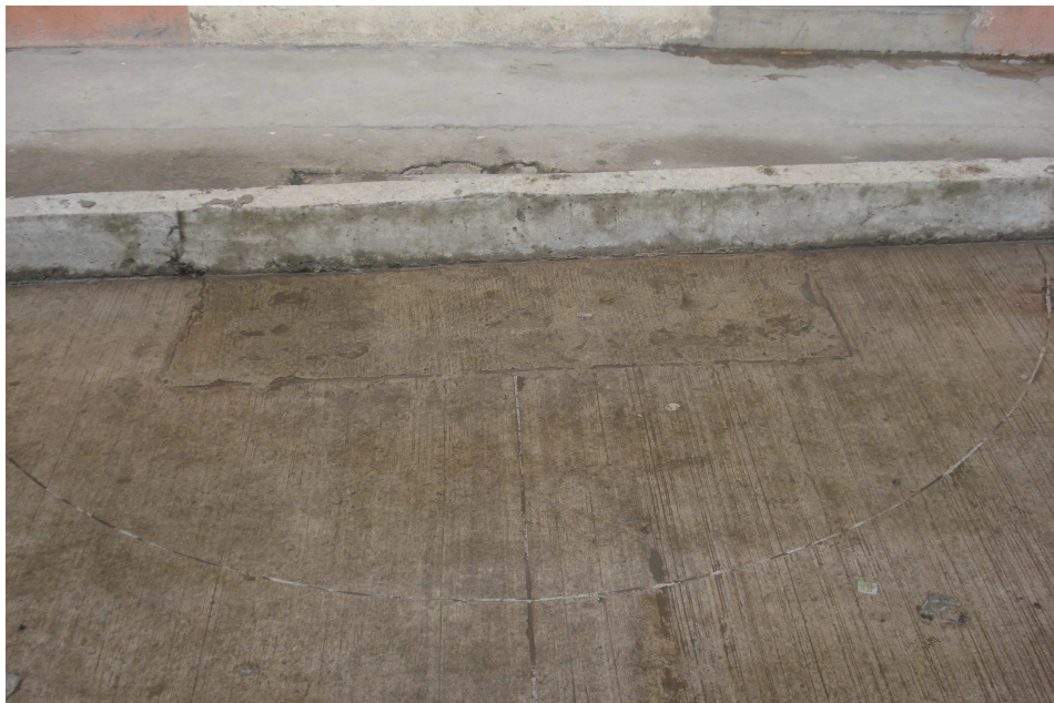
Figura 43. Sumidero sellado para evitar taponamientos.
