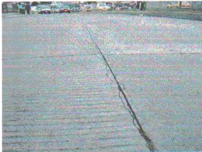
Detalle de una de las grietas presentadas a lo largo de la junta longitudinal del pavimento.
