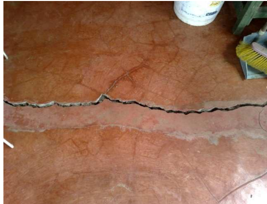
Figura 48. Piso agrietado en la vivienda de Veracruz.
