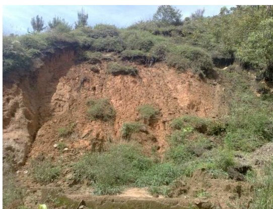
Figura 34. Talud que hizo colapsar una vivienda en la vereda La Aguada.
