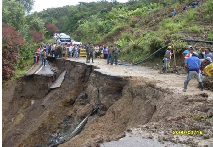
Figura 45. Caída de banca vía Pasto – Buesaco
