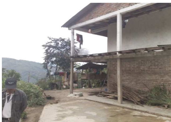
Figura 22. Pésimo sistema estructural
