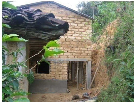
Figura 42. Vivienda que tiene un sistema estructural no definido.
