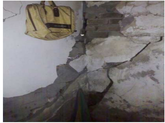
Figura 7. Grietas por empujes laterales
