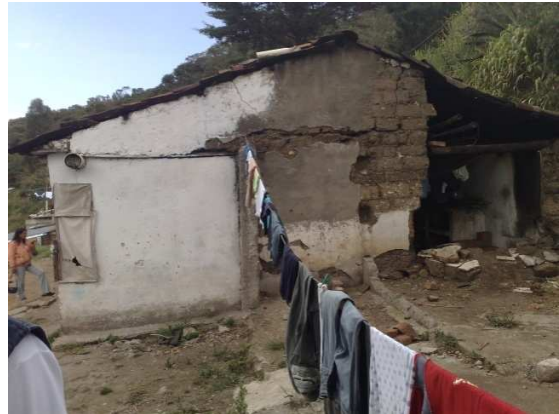
Figura 10. Grietas por empujes
