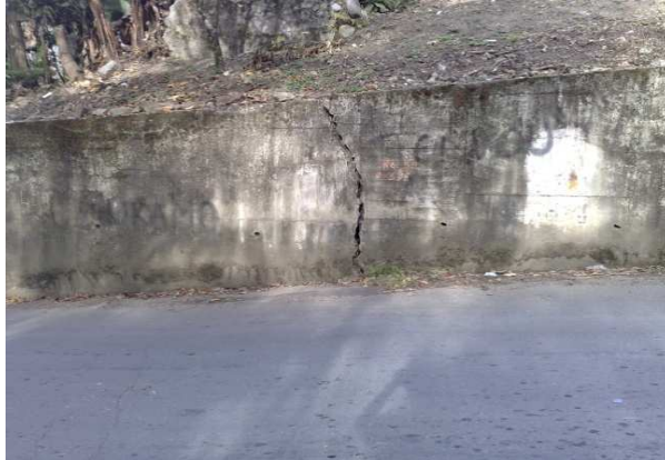
Figura 8. Falla de muro de contención.
