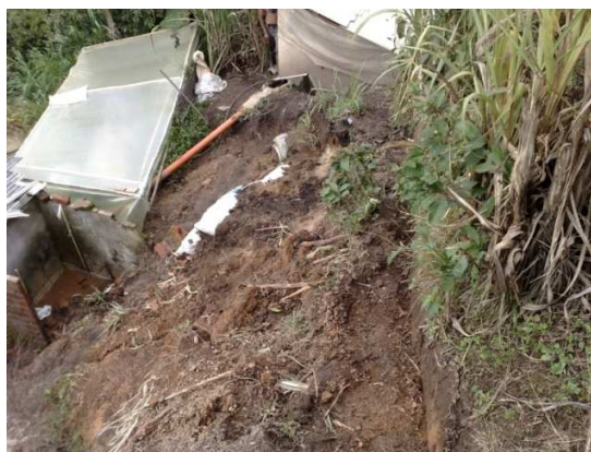
Figura 33. Colapso de un baño debido a un deslizamiento.
