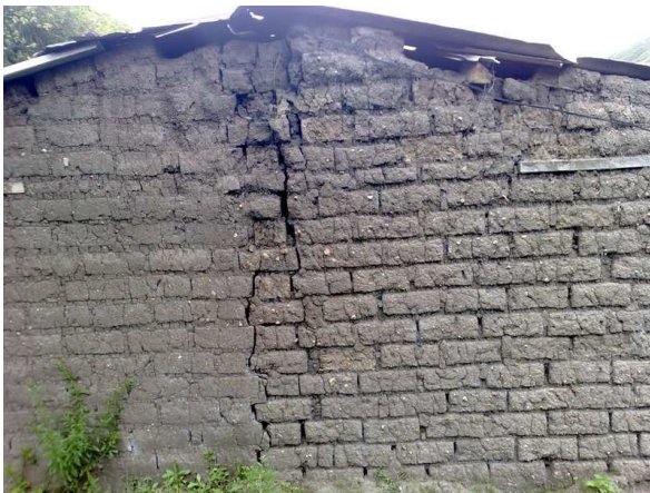
Figura 18. Escasa tensión y adherencia
