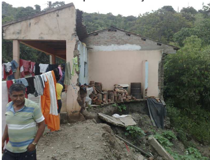
Figura 16. Daño en elementos arquitectónicos y estructurales
