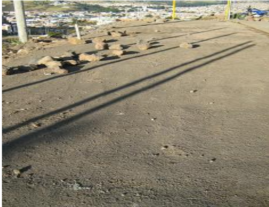
Figura 62. Estado base compactada
