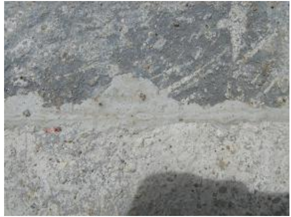
Figura 135. Aspecto de la junta
