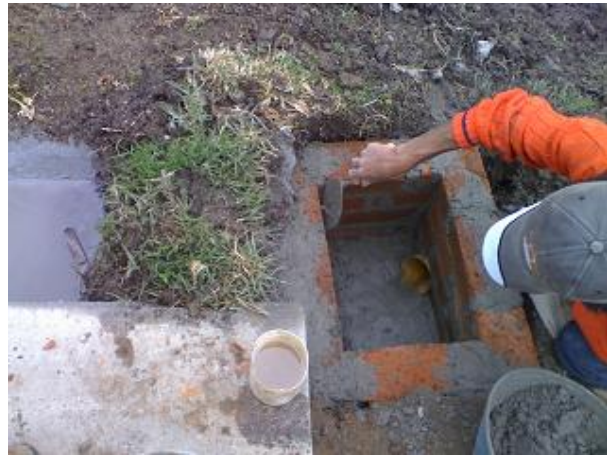
Figura 18. Caja de inspección.
