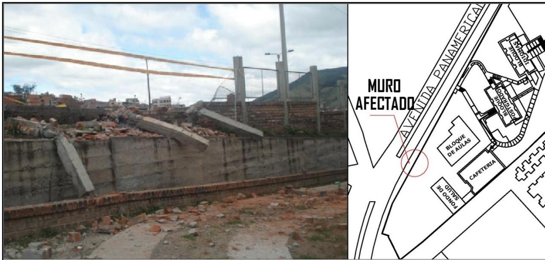
Figura 121. Localización de muro afectado
