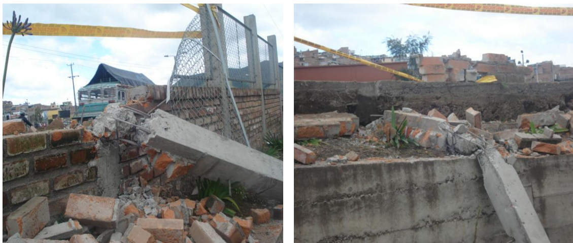
Figura 122. Daños a causa del accidente
