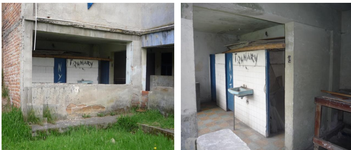
Figura 130. Estado de unidades sanitarias
