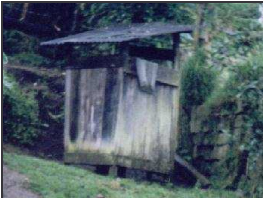
Poso séptico parte de la vivienda indígena
