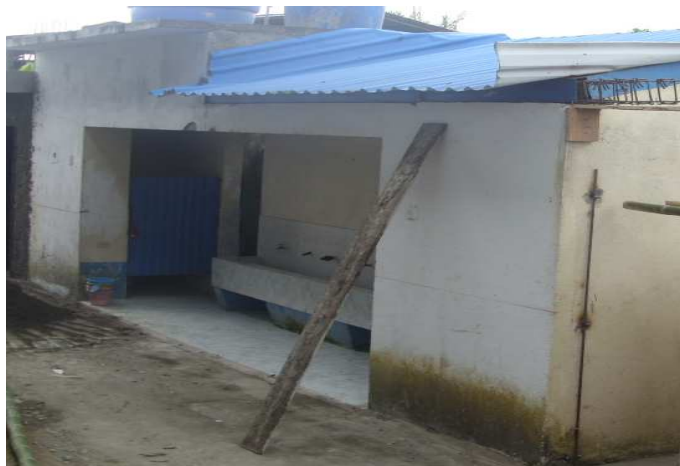
Foto 60. Estado inicial de la batería sanitaria de niñas
