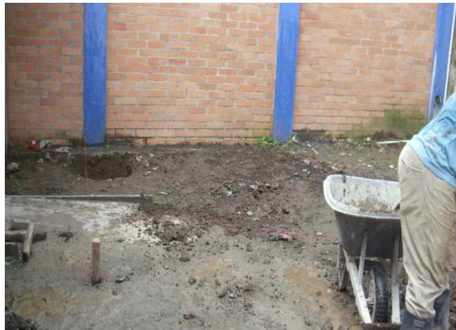
Foto 62. Localización de la batería sanitaria nueva
