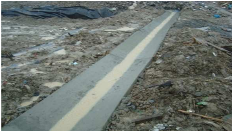
Foto 153. Cuneta en funcionamiento
