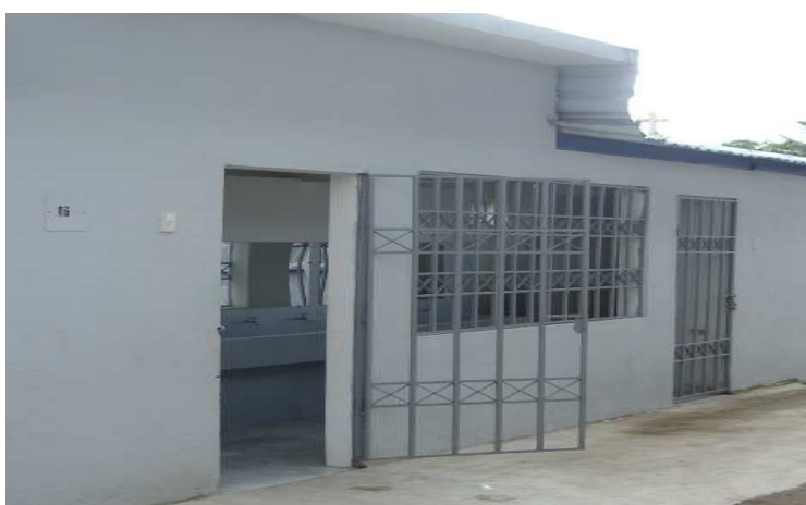
Foto 119. Vista de la batería sanitaria de niñas adecuada
