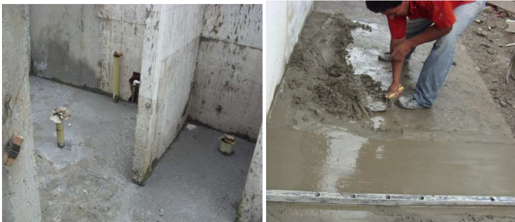
Foto 110 y 111. Placa de piso y andenes
