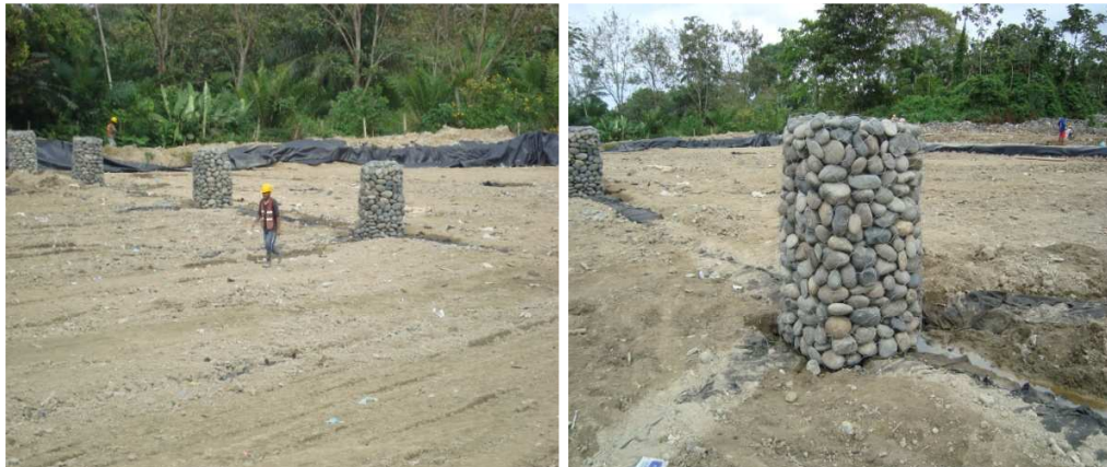
Foto 147 y 148. Chimeneas para control de gases
