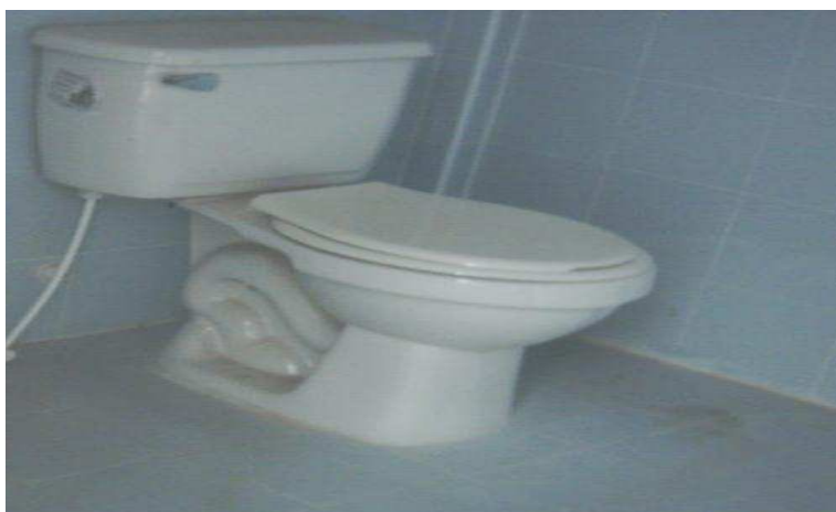
Foto 118. Muebles sanitarios instalados
