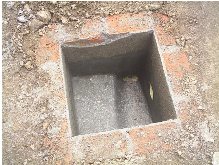
Figura 46. Caja de inspección
