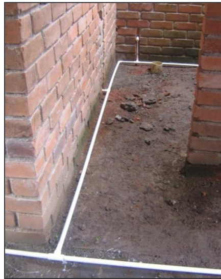
Figura 51. Instalación hidráulica de baño
