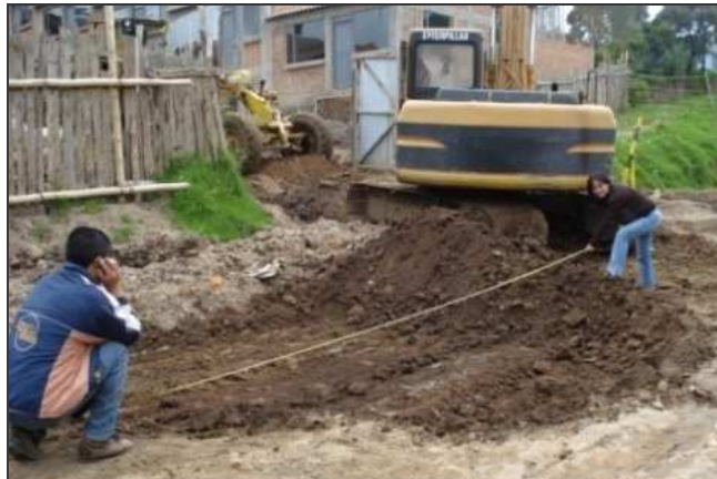
Figura 78. Medición de bache en la carrera 32
