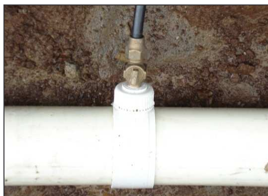
Figura 54. Registro de incorporación y tubería PF + UAD
