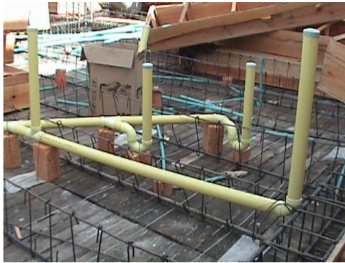
Foto 85. Tubería de instalaciones Sanitarias
