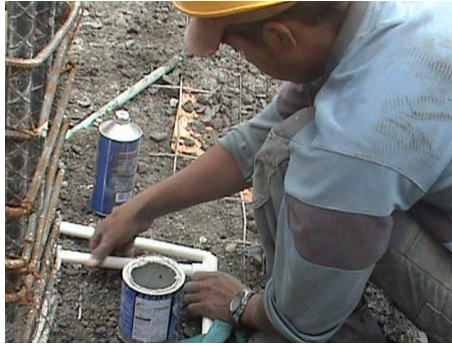
Foto 86. Tubería de instalaciones hidráulicas en plaqueta superior.
