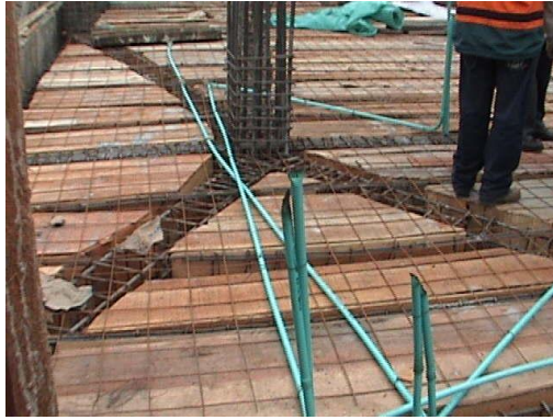
Foto 83. Instalaciones de tubería en plaqueta superior.
