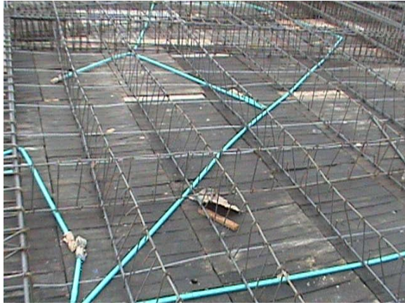
Foto 82. Instalaciones de tubería en plaqueta inferior.
