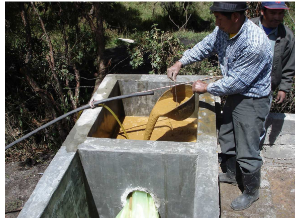
Foto 21: se llena de residuos porcinos la cámara Fuente: Esta investigación.
