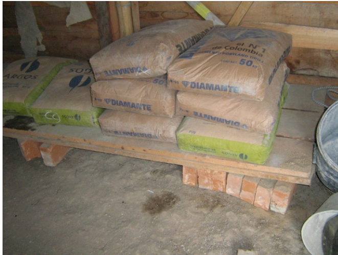
Foto 26. Almacenamiento del cemento
