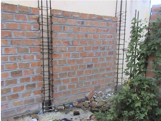
Foto 14. Diámetro de flejes inadecuado en columnas
