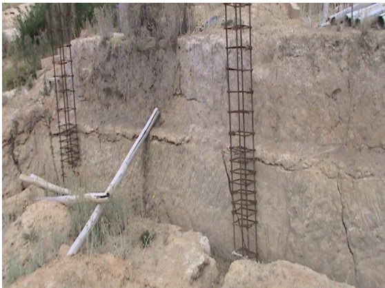
Foto 4. Fisuras del terreno por terraceos
