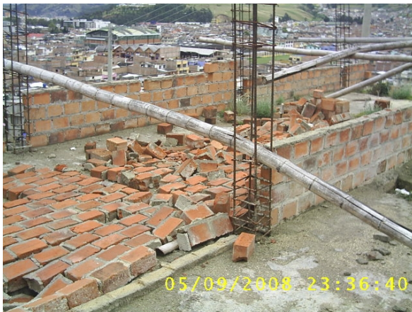
Foto 7. Muros de poca resistencia
