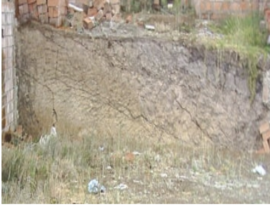
Foto 3. Fisuras del terreno
