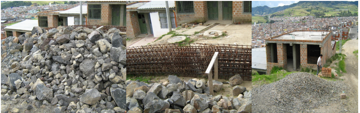
Foto 2. Almacenamiento de materiales al aire libre
