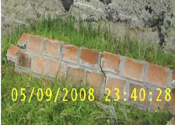
Foto 8. Fisuras en muros
