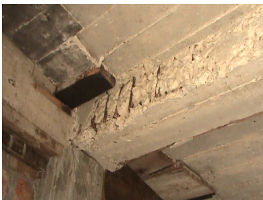
Foto 11. Hormigueros y recubrimientos insuficientes
