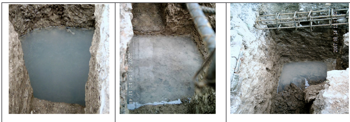
Figura 6. Presencia de agua estancada por daños en tuberías vecinas.
