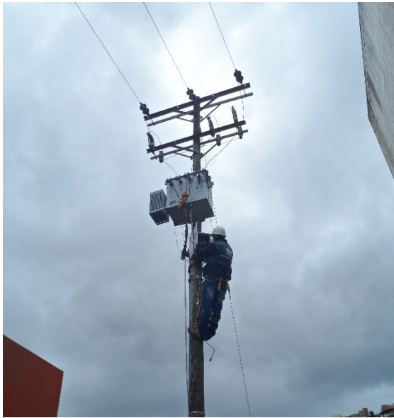
a) Montaje analizador de redes HIOKI
