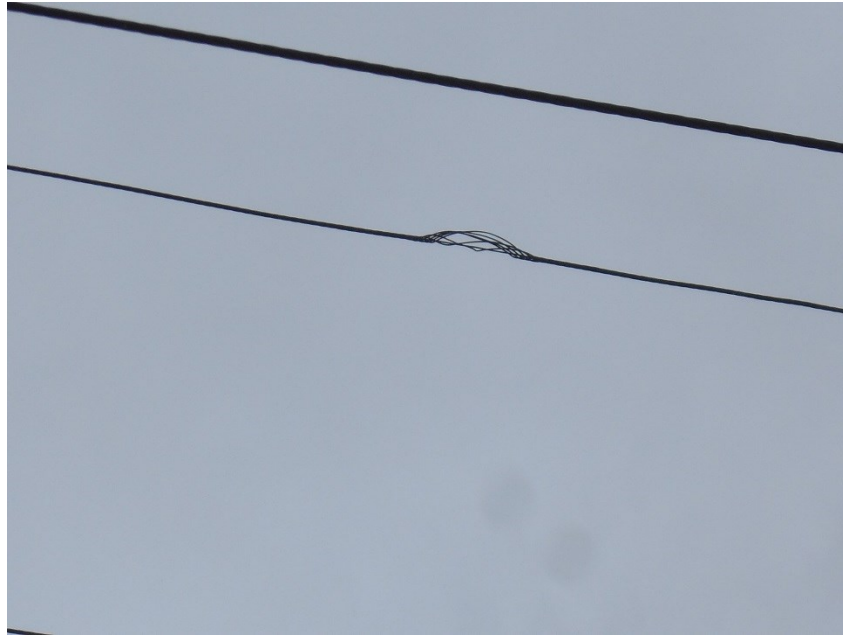
Figura 1. Acometida principal red eléctrica interna UDENAR
