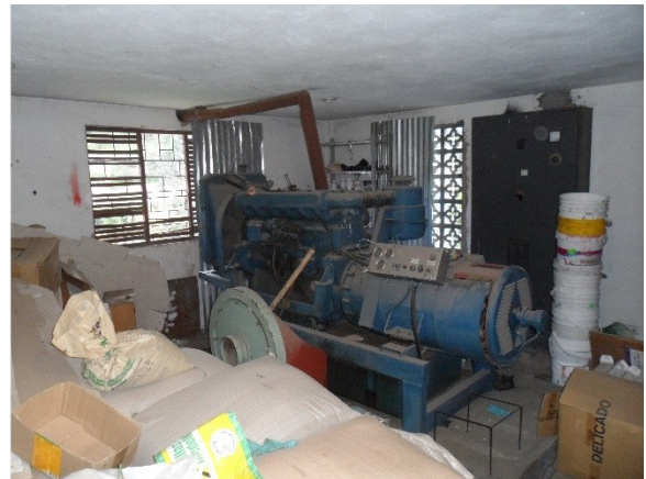
b) TG-6 acceso tapado y almacenamiento inapropiado
