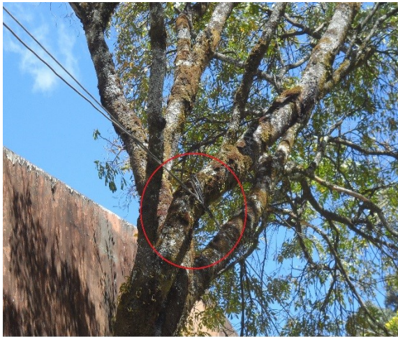
a) Inadecuada estructura de soporte permitidas
