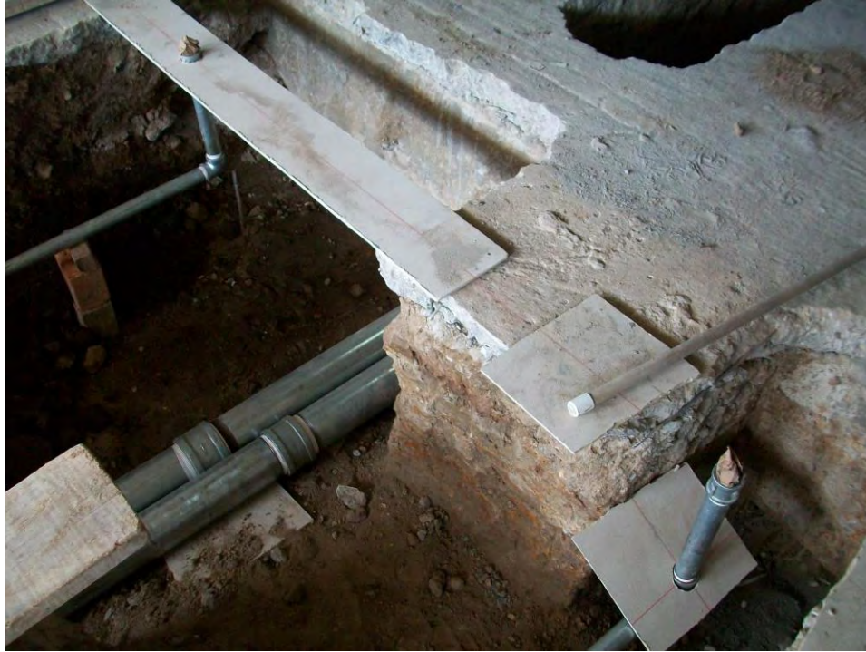
Figura 39. Red de cámara de retención y enfriamiento en HG.
