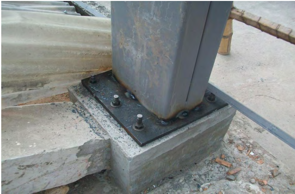
Figura 15. Anclajes sobre pedestal en concreto reforzado
