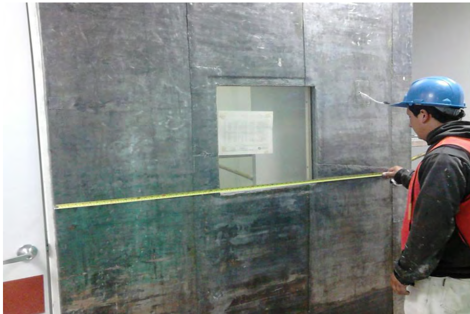
Figura 4. Muros plomados en rayos X con plomo de 2 mm de espesor.
