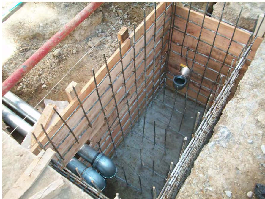
Figura 7. Cámara de retención y enfriamiento con red en HG.
