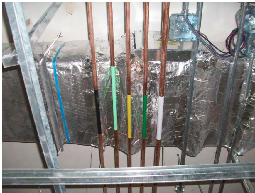
Figura 42. Red de gases medicinales señalizada.
