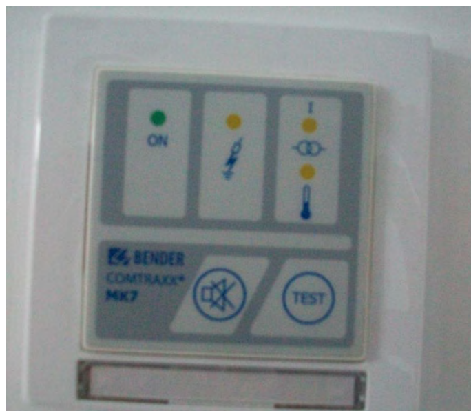
Figura 35. Panel de aviso de tableros aislados
