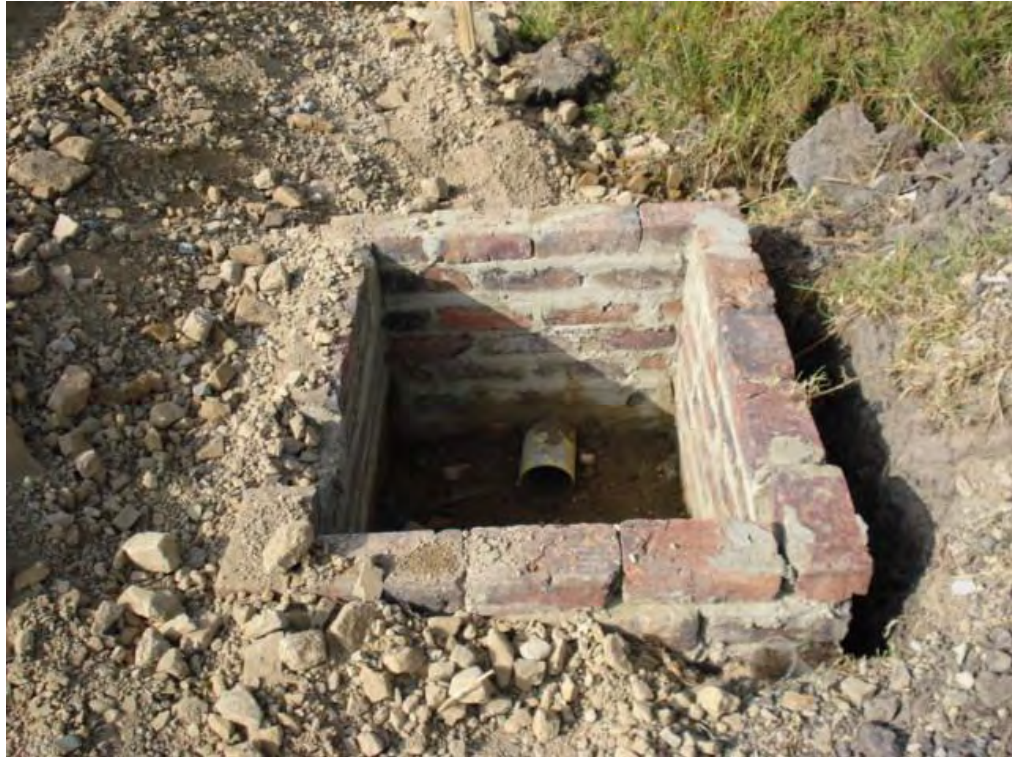
Imagen 6. Cajas de Inspección
