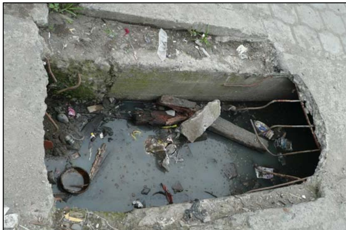
Figura 6. Canales de conducción de aguas residuales
