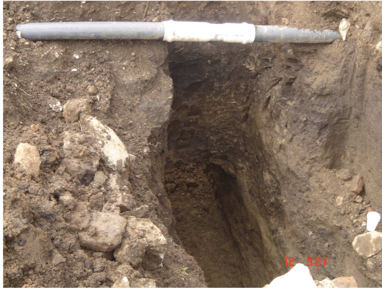
Foto No. 34 Tuberías averiadas
