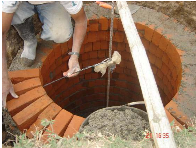
Figura 51. Cámara de inspección
