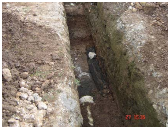
Figura 60. Sistema de filtración
