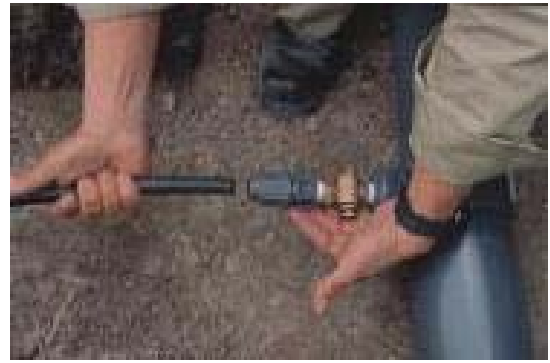
Figura 30. Inst. tubería PF + UAD
