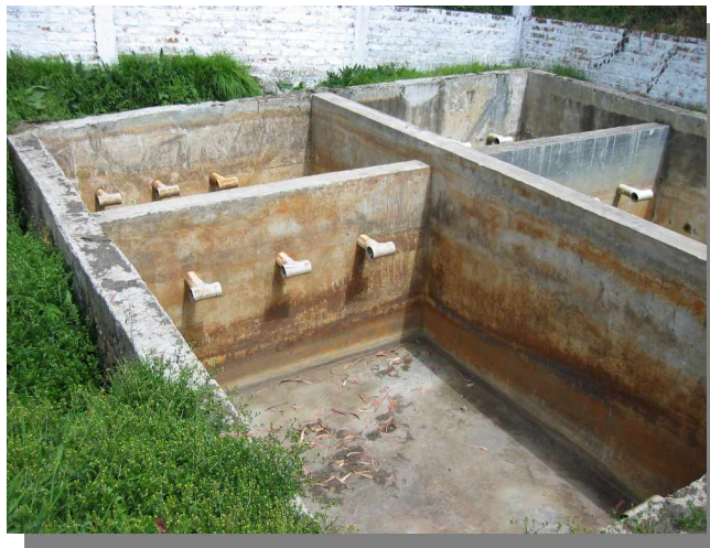
Figura 7. Pozos sépticos abandonados – Centro Poblado de Chiles
