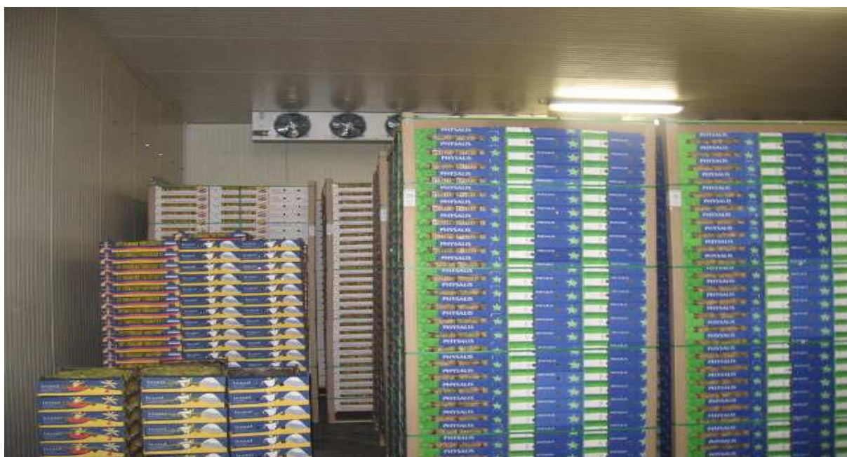
FIGURA 6: FOTOGRAFÍA CUARTO FRÍO COOMCUYNAR (Octubre de 2007)
