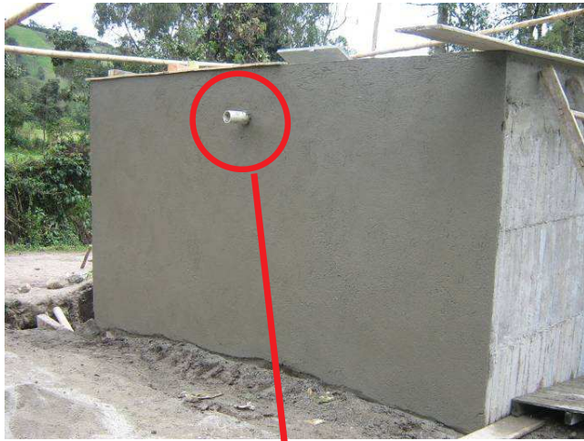
Figura No 73. Tubería de entrada 3"
