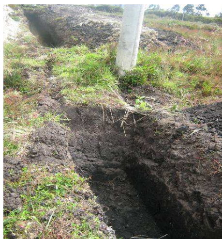
Figura No 6. Inconvenientes de excavación
