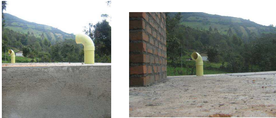
Figura No 75. Conos de ventilación 4"
