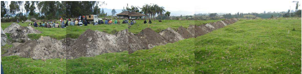
Figura No 80. Panorama general de la red de distribución.
