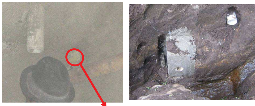
Figura No 77. Tubería de desagüe 3"
