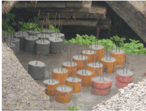
Figura No 56. Cilindros para mantener el recubrimiento del refuerzo en la fundición de la placa de piso.
