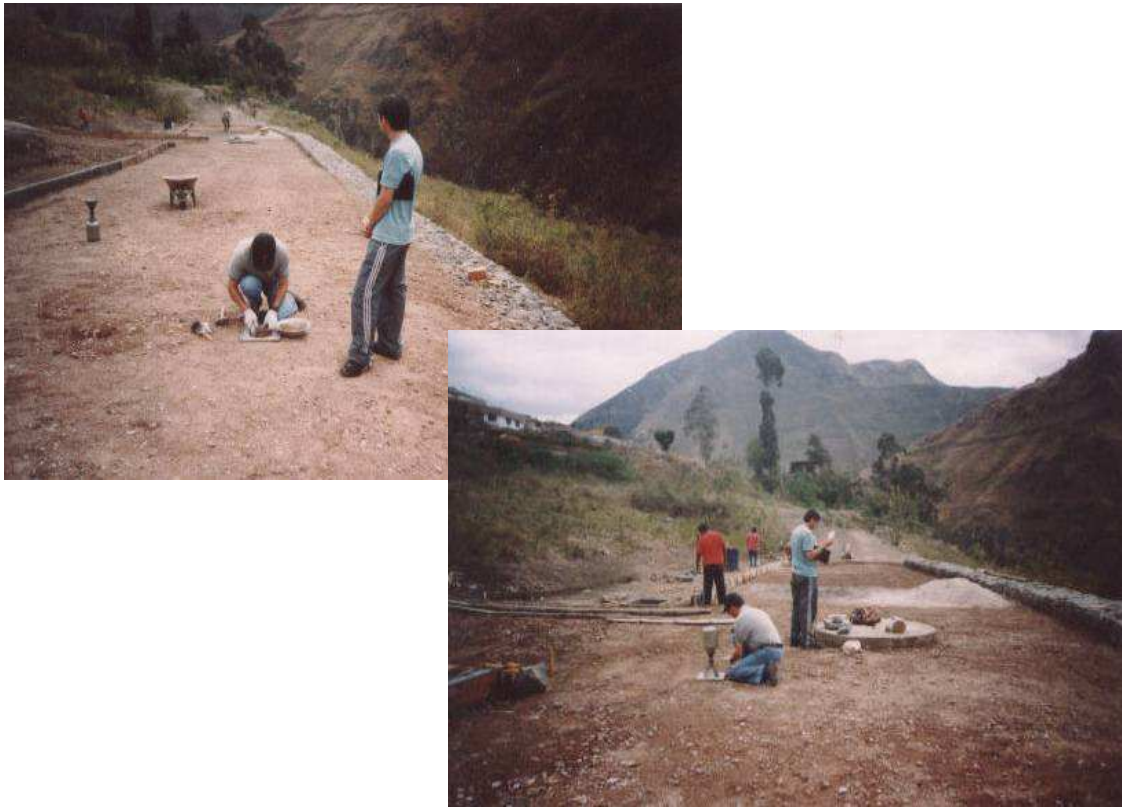
Figura No 40. Control de humedad
