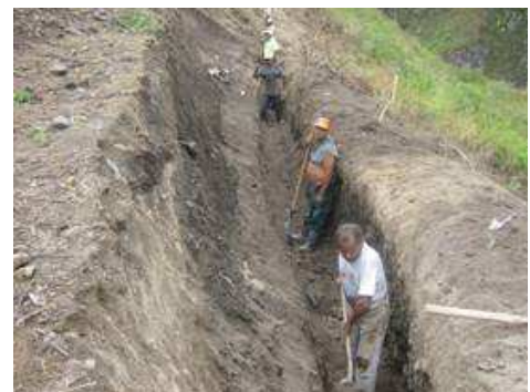
Figura No 25. Deslizamientos en excavación
