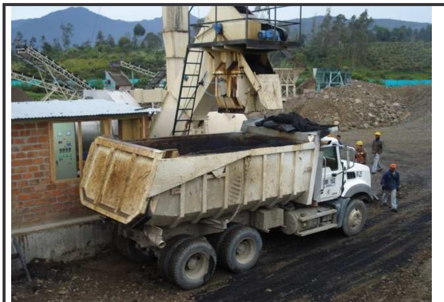
Figura 56. - Tolva de descarga - 90 seg./bachada
