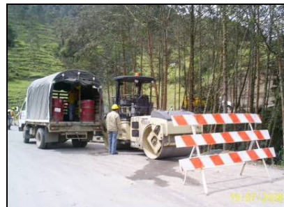
Figuras 106. Suministro de combustible “in situ”
