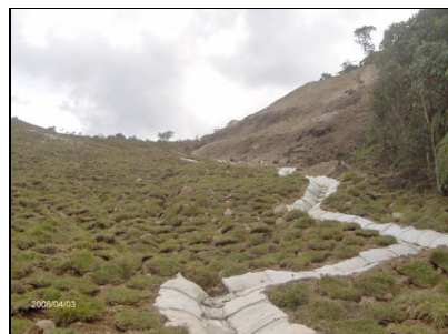
Figuras 99. Manejo de corrientes de agua: canal en bolsacreto dep. No 008 – k46+500 -
