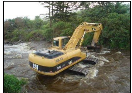
Figura 27. Adecuación del sistema de captación para los criaderos de trucha – Corregimiento de San Pedro.
