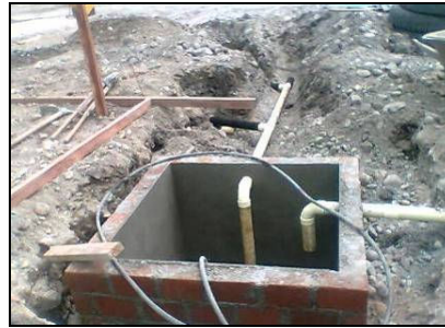
Figuras 104. Trampa de grasas y campo de infiltración - talleres
