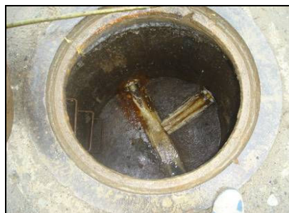
Figura 140. Red de alcantarillado en el Barrio Santa Teresita
