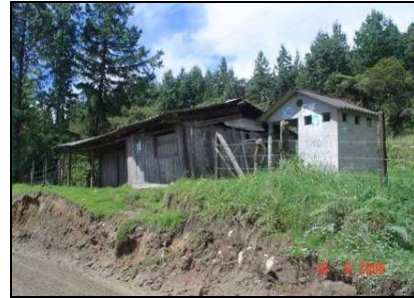
Figura 62. Estado general de las viviendas de: Eduardo Ramos
