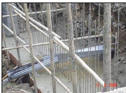
Figuras 94. Manejo de corrientes de agua: construcción de muro y alcantarilla k27+640
