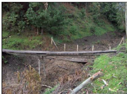
Figura 130. Adecuación de accesos y alcance del deslizamiento del Dep. No 008
