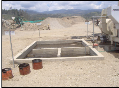
Figuras 103. Zona de sedimentación y recirculación de agua para la planta de asfalto
