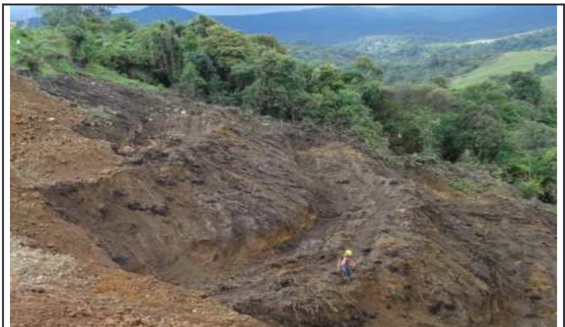
Figura 31. Deposito con terrazas. K46+500
