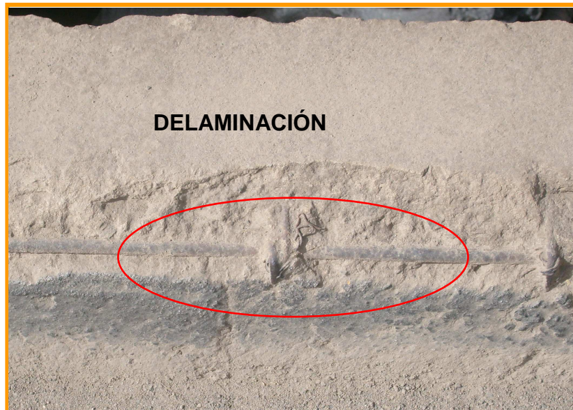
Figura 45: Delaminación en vigas
