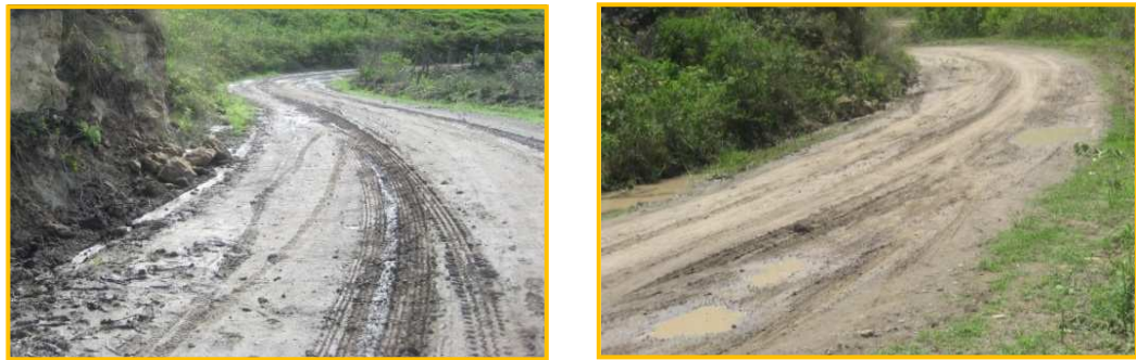
Figura 8. Condiciones de la vía después de periodos de lluvia.
