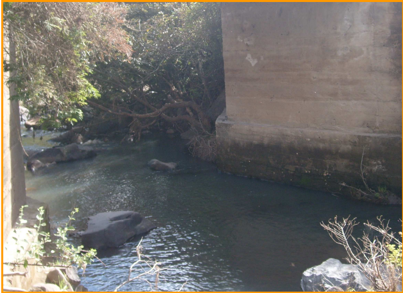
Figura 41: Estado del cauce
